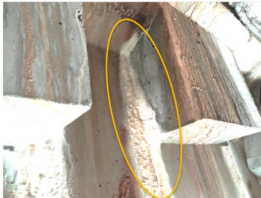
Figura 72 Circulación de agua con deposiciones blanquecinas de carbonatos, fruto de la clara circulación de agua a través del hormigón de los cajetines de protección del pretensado.
