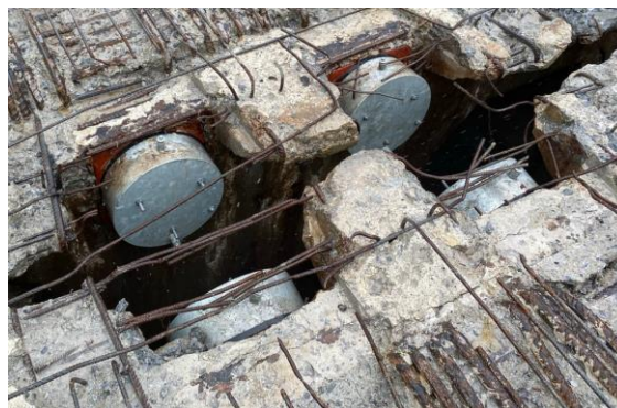
Figura 94 Detalle de cabezas de pretensado prácticamente a escasos centímetros de la cara superior del mamparo en la zona rebajada para la losa de discontinuidad.
