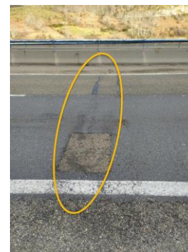
Figura 245 Fisuración de losa de continuidad y degradación del firme en estado más avanzado
