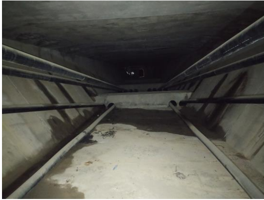
Figura 11 Vista general de interior de cajón en donde se observa claramente la presencia de agua en su interior, así como las manchas y humedades en las almas, fruto de la entrada de agua a través de los pasatubos de losa.
