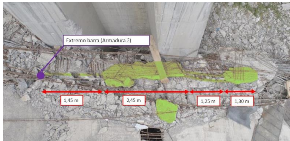
Figura 292 Vano 1. Mamparo 2. Frangentos de losa de la dovela del mamparo, apoyados, tras el colapso de la estructura, sobre la propia cabeza del mamparo..
