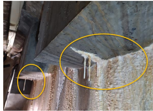
Figura 73 Fisuración de cajetín de sellado del pretensado con circulación de agua y presencia de deposiciones de carbonatos en forma de estalactitas.
