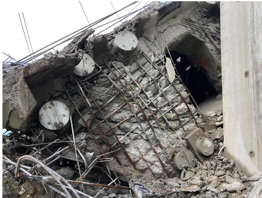
Figura 182 Vano 2. Mamparo 2. Vista general exterior desde el lateral derecho. Integridad aparente del mismo. En la imagen pueden observarse los significativos daños de tipo durable presentes en la cara inferior de la dovela del mamparo y anterior, así como en el propio alma.
