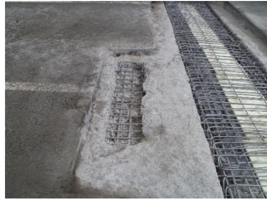
Figura 263 Detalle de hormigón degradado sobre cabeza de mamparos y frente de losa en 2013. Fuente: COPASA
