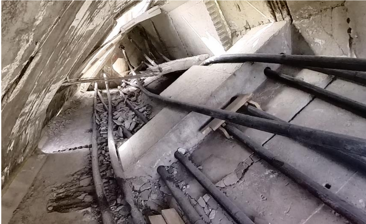
Figura 202 Vano 3. Desviador D5. Vista general. Aparente integridad del mismo, salvo en su lateral derecho que se encuentra "arrancado" del alma, aparentemente fruto de la caída del vano sobre el terreno a media ladera.
