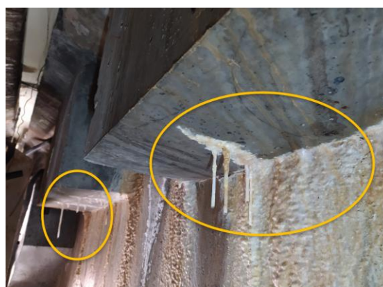
Figura 8 Fisuración de cajetín de sellado del pretensado con circulación de agua y presencia de deposiciones de carbonatos en forma de estalactitas.
