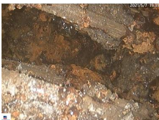
Figura 248 Inspección previa con boroscopio de cable sin tensión. Corrosión generalizada de torones, incluso constatando su rotura. FUENTE: ESTEYCO-BAGH
