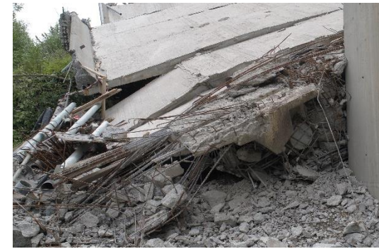
Figura 138 Vano 1. Mamparo 2. Vista general exterior desde el frontal (mirando desde pk+) derecho. A destacar el importante nivel de daño.
