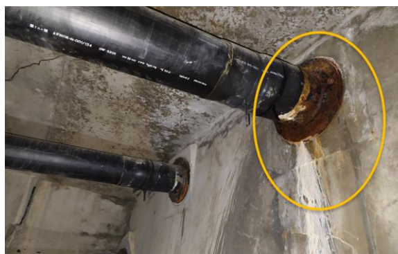
Figura 10 Ídem anterior. Nótese además la presencia circulación de agua con deposiciones blanquecinas bajo el tubo de salida del mamparo
