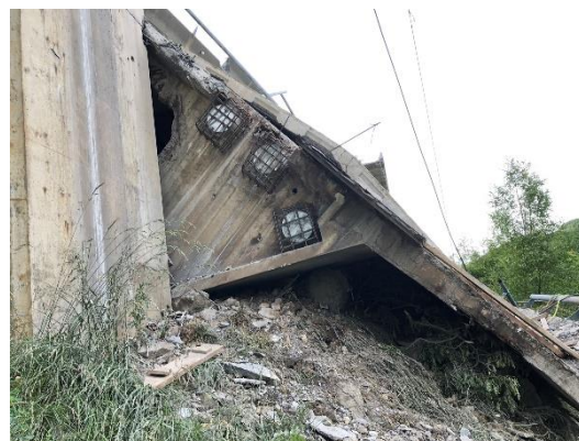
Figura 289 Vista general de mamparo lado Madrid del vano V3 colapsado. Aparente inegridad física.
