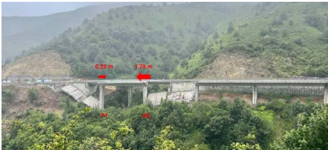
Figura 116 Vista general de viaducto. Desplazamientos de cabezas de pilas previo a la demolición del vano V-2. Fuente: Intemac
