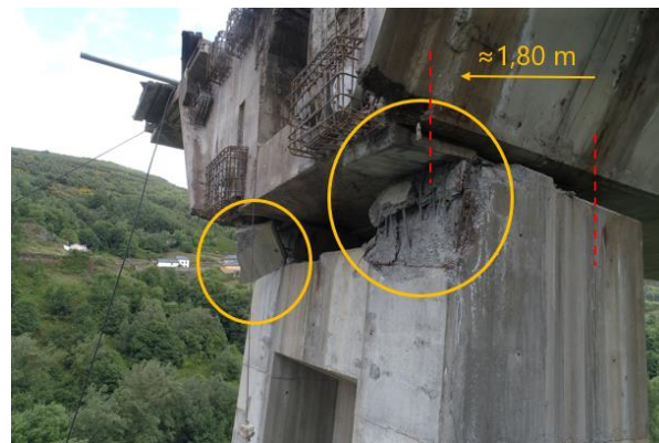
Figura 103 Detalle de cabeza de pila P2 tras colapso de vano V3, en donde claramente se observa el movimiento en cabeza de pila del orden de 1,80m.
