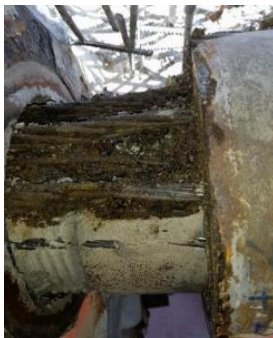
Figura 40 Bloque despegado tras corte de tendón. Lechada incompleta, de mala consistencia. Corrosión y rotura de cables. Fuente: Freyssinet
