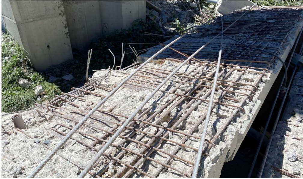
Figura 164 Vano 2. Mamparo 1. Vista general exterior del mamparo donde se puede observar el saneo con hidrodemolición realizado.
