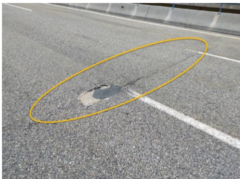
Figura 59 Fisuración de losa de continuidad y degradación del firme
