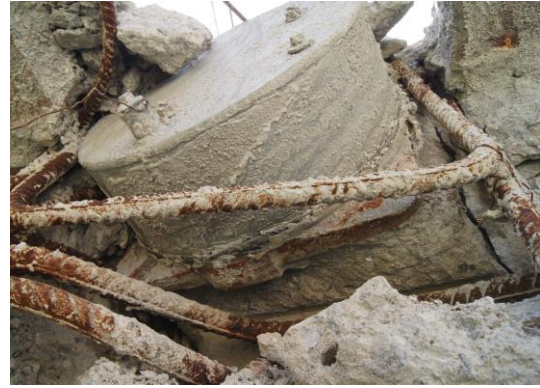
Figura 192 Vano 3. Mamparo 2. Detalle de tendón superior derecho. Nuevamente se observa la aparente integridad del bloque de hormigón zunchado entre el hormigón fragmentado, observándose, incluso, una grieta en el lateral derecho de la imagen.
