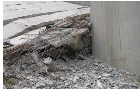
Figura 291 Mamparo del lado Coruña del vano 1 fuertemente “estallado” tras colapso de vano y efecto de la caída
