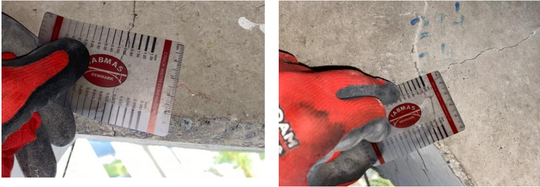
Figura 189 Vano 3. Mamparo 2. Vista interior de riostra superior de paso de hombre. Fisuración de eje vertical. Apertura de fisura máxima del orden de 1,5mm
