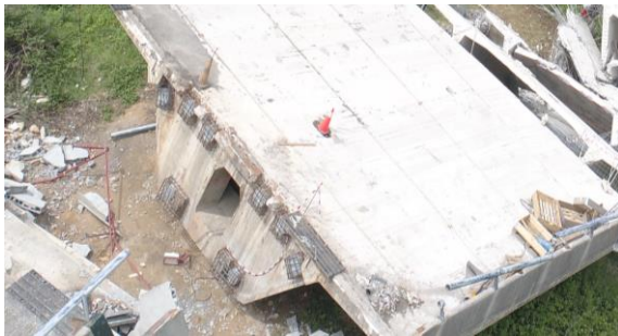
Figura 290 Mamparo del lado Madrid del vano 1 tras su colapso, con aparente integridad.
