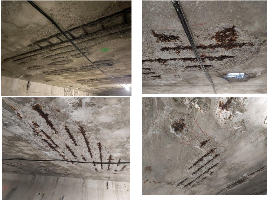
Figura 266 Desconchones con armadura en avanzado estado de corrosión en la losa superior, fruto de la ausencia impermeabilización del tablero.
