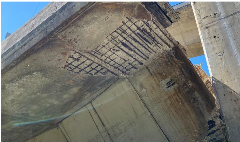
Figura 172 Vano 2. Mamparo 2. Vista general exterior desde el lateral derecho. Integridad aparente del mismo. En la imagen pueden observarse los significativos daños de tipo durable presentes en la cara inferior de la dovela del mamparo y anterior, así como en el propio alma.
