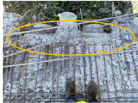
Figura 171 Vano 2. Mamparo 1. Detalle de vista superior de anclajes de pretensado. Nótese la rotura de las armaduras longitudinales de losa como consecuencia del deficiente funcionamiento de las losas de continuidad.
