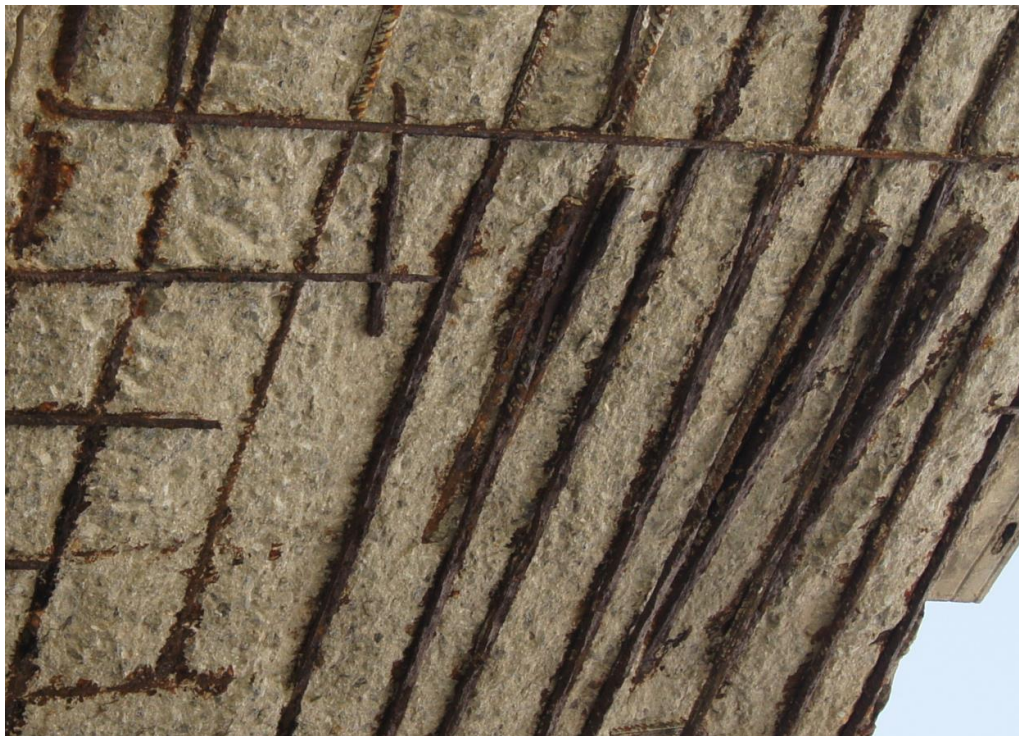
Figura 178 Vano 2. Mamparo 2. Detalle de estado de armadura en la cara inferior del voladizo anterior.
