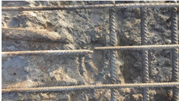
Figura 57 Rotura de armaduras por corrosión en zona saneada. Fuente: COPASA 2020
