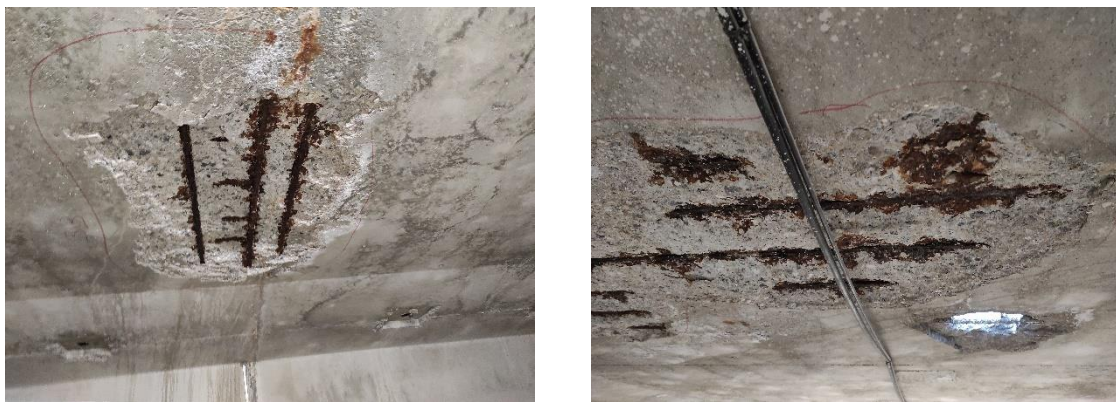
Figura 66 Desconchones con armadura en avanzado estado de corrosión en la losa superior
