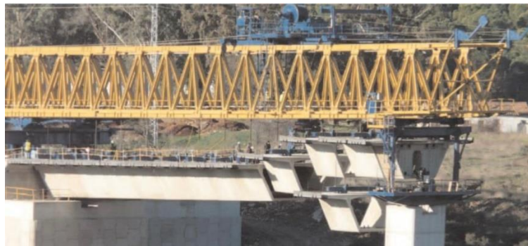
Figura 253 Vista general del sistema constructivo de dovelas conjugadas prefabricadas con postesado exterior.
