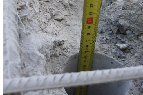
Figura 169 Vano 2. Mamparo 1. Medición del espesor residual de losa tras retirada del hormigón "inerte" por encima de la junta fría.
