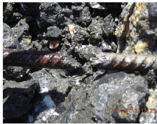
Figura 265 Detalle de armaduras rotas por corrosión detectada durante los trabajos de reparación del año 2013. Fuente: COPASA
