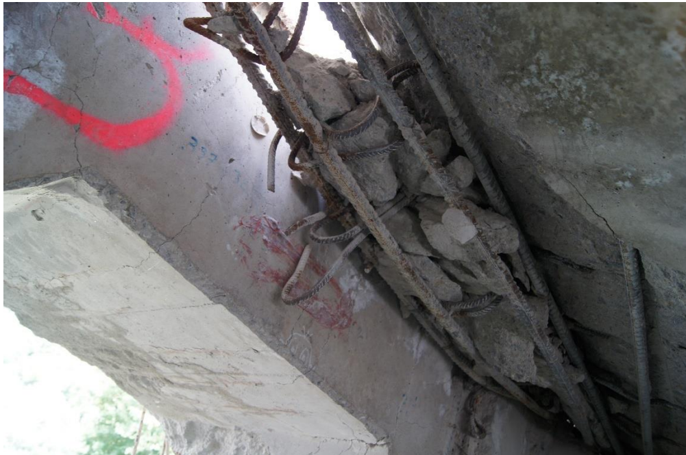
Figura 188 Vano 3. Mamparo 2. Vista interior de riostra superior de paso de hombre. Fisuración de eje vertical. Apertura de fisura máxima del orden de 1,5mm.
