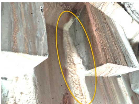
Figura 64 Circulación de agua con deposiciones blanquecinas.
