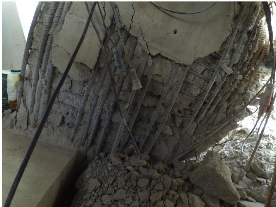
Figura 186 Vano 3. Mamparo 2. Vista interior derecha del mamparo. Desprendimiento del hormigón de recubrimiento interior, más acusado en su lateral derecho.
