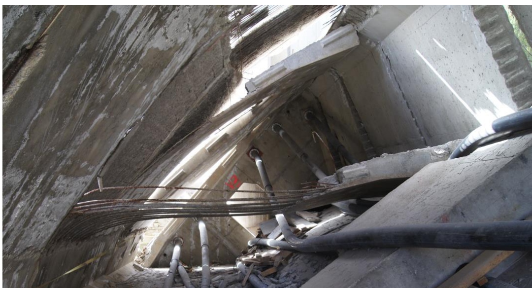
Figura 204 Vano 3. Vista general del interior del vano V3 desde el centro de vano, aproximadamente hacia el mamparo 1, donde se pueden observar 2 dovelas contiguas con una clara rotura con delaminación del hormigón por su cara inferior.
