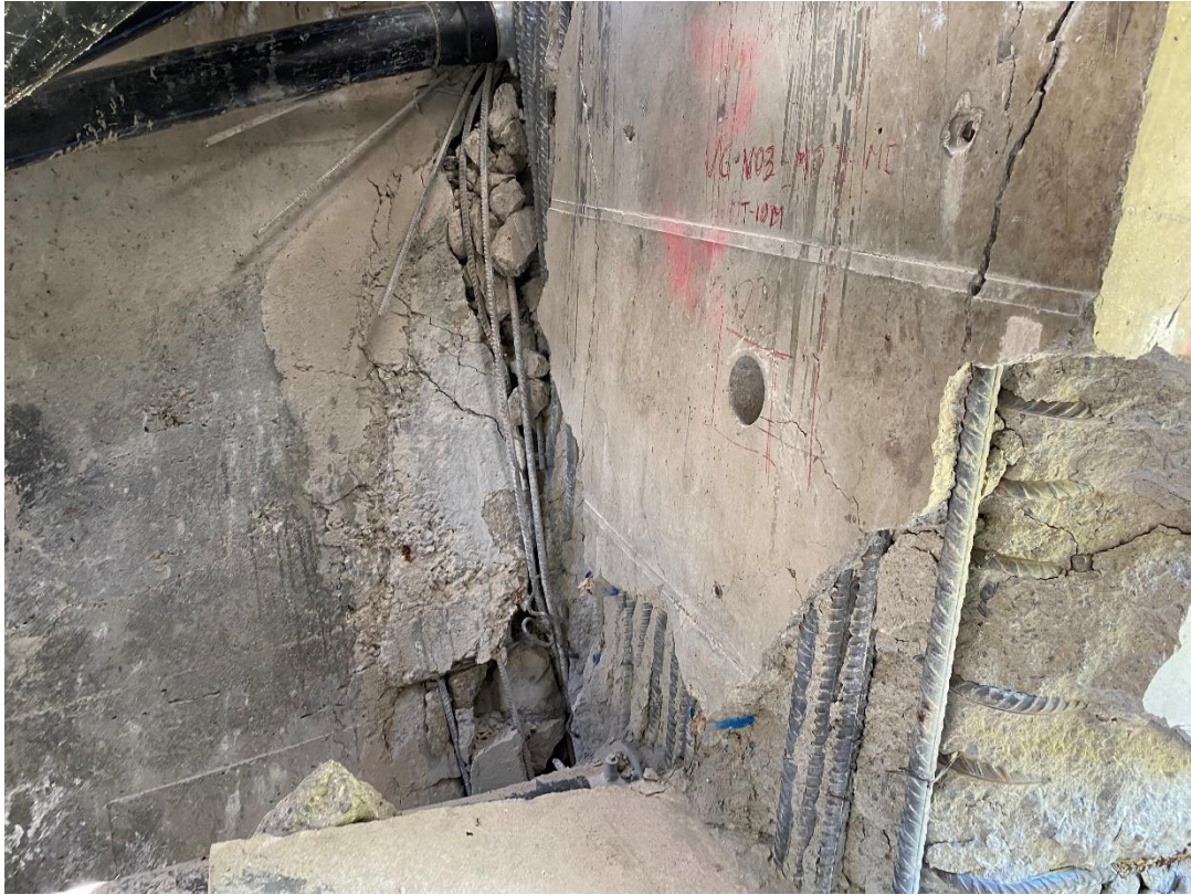
Figura 187 Vano 3. Mamparo 2. Vista interior izquierda del mamparo. Desprendimiento del hormigón del recubrimiento en la parte inferior. Rotura lateral del alma en su contacto con el mamparo, con, aparentemente, cierta delaminación de la pieza.
