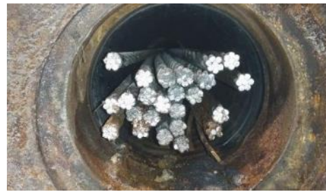
Figura 39 Extremo de tendón original tras retirada de bloque de cuñas y tromplaca. Ausencia de lechada. Corrosión y rotura de cordones. Fuente: Freyssinet
