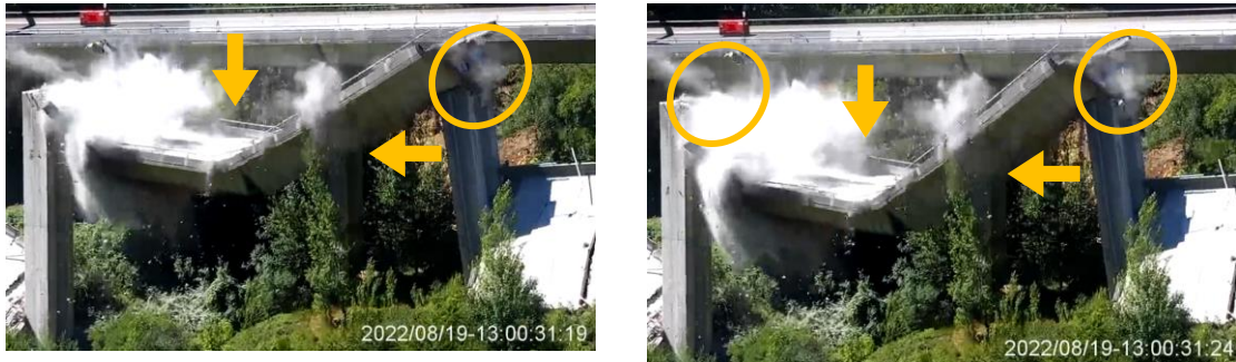
Figura 126 Caída a plomo de tramo corto con pérdida completa de apoyo en P1. Caída de tramo central también a plomo y tramo extremo de P2 pivotando todavía sobre cabeza de pila. Fuente imagen: DGT
