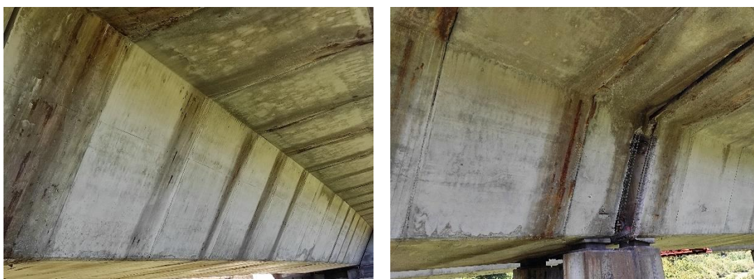
Figura 261 Filtración de agua, eflorescencias, lajaciones, manchas de óxido en las juntas entre dovelas y almas del cajón
