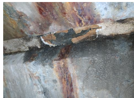
Figura 6 Detalle de cara inferior de losa de continuidad con claros indicios de circulación de agua y corrosión de las armaduras.
