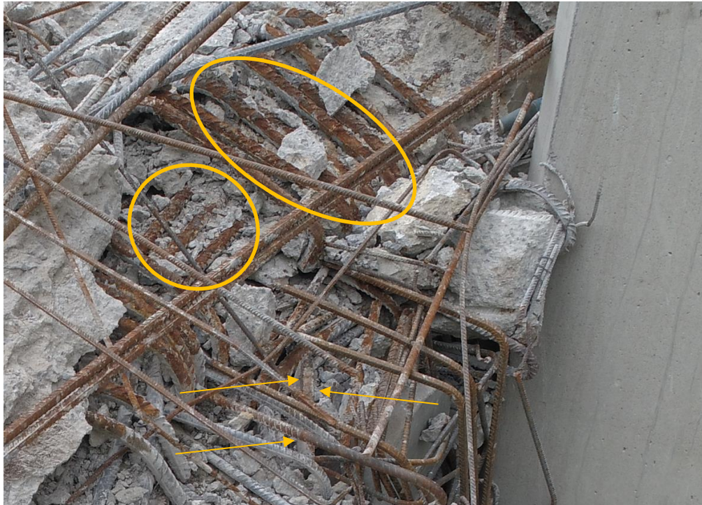
Figura 146 Vano 1. Mamparo 2. Vista superior del anclaje exterior superior derecho, en donde se puede apreciar la importante corrosión del tramo horizontal de las armaduras principales del mamparo, así como el hundimiento del bloque de pretensado (cercos de confinamiento vistos) y la rotura de la placa del pretensado.
