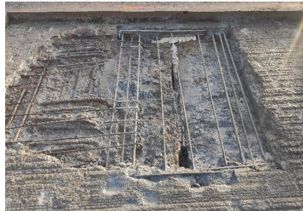
Figura 303 Vista de zona de losa dañada tras saneo del hormigón degradado. Avance del nivel de deterioro. Mayor corrosión de armaduras. Fuente: COPASA 2020
