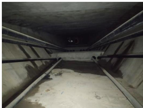
Figura 258 Vista general del cajón en donde se observa claramente la presencia de agua en su interior, así como las manchas y humedades en almas, fruto de la entrada de agua a través de los agujeros/pasa tubos de cuelgue de las dovelas en construcción
