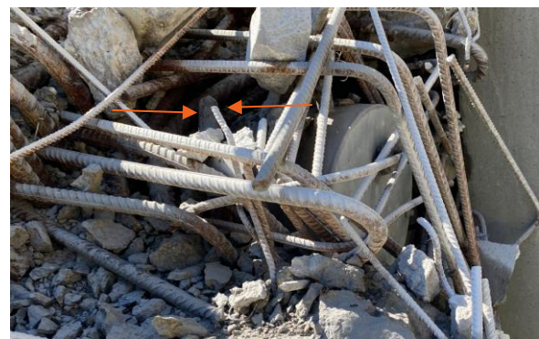
Figura 110 Vano 1, mamparo Coruña. Detalle de anclaje T3 en donde se puede ver el hundimiento parcial de la placa de anclaje del pretensado, así como la rotura de la propia placa de anclaje (Imágen obtenida tras realización de caminos de acceso)
