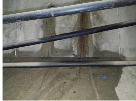
Figura 12 Detalle de humedades en almas de interior de cajón bajo tubos de cuelgue de dovelas.
