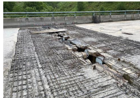
Figura 101 Vista general de losa saneada sobre pila P1. A la izquierda, vano 1, colapsado en 2ª instancia; a la derecha, vano 2.
