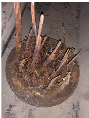
Figura 85 Detalle de bloque afectado por la corrosión del cable inicialmente detectado roto.
