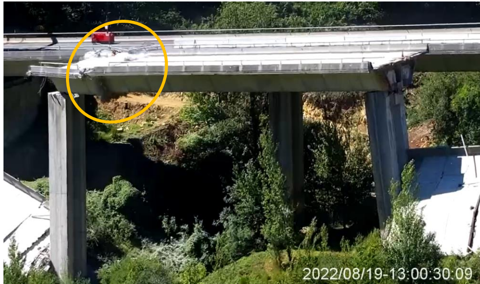
Figura 123 Rotura/estallido de la sección de picado por compresión del hormigón. Fuente imagen: DGT
