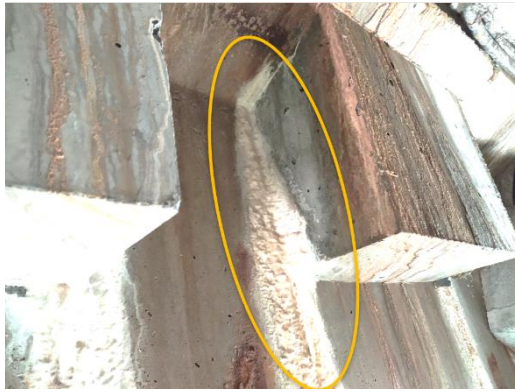
Figura 267 Circulación de agua con deposiciones blanquecinas de carbonatos, fruto de la clara circulación de agua a través del hormigón de los cajetines de protección del pretensado.
