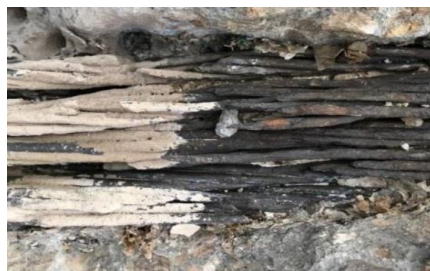
Figura 256 Ejemplo de pretensado interior con torones rotos por corrosión. A ausencia de lechada
