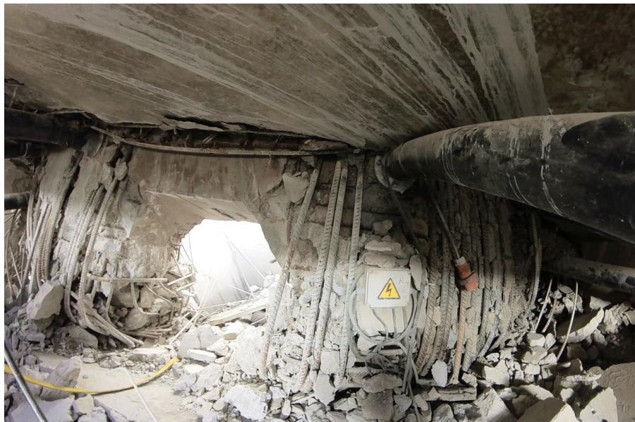
Figura 139 Vano 1. Mamparo 2. Vista general interior. Se observa el desprendimiento de gran parte del recubrimiento interior del hormigón, dejando las armaduras principales del mamparo descubiertas, las cuales presentan una gran deformación.
