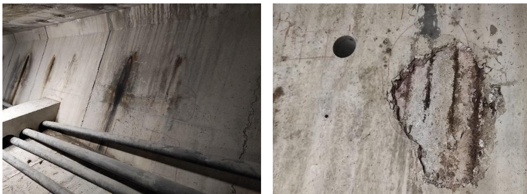
Figura 260 Humedades, manchas de óxido y desconchones en el alma en zonas bajo pasatubos
