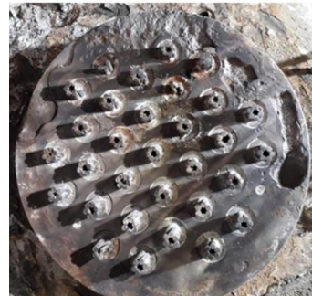
Figura 79 Vista general del frente de anclaje en la zona rota, donde se puede observar el deslizamiento de los cables centrales de los cables del pretensado. Fuente: Esteyco
