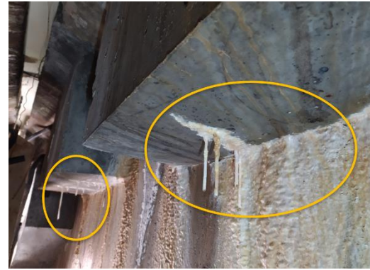
Figura 268 Fisuración de cajetín de sellado del pretensado con circulación de agua y presencia de deposiciones de carbonatos en forma de estalactitas.
