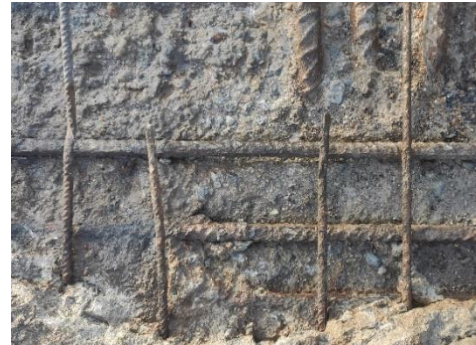
Figura 58 Detalle de armaduras rotas, incluso desaparecida/retirada su continuidad por su alta degradación. Fuente: COPASA 2020
