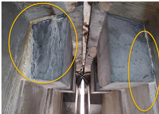
Figura 62 Circulación de agua con deposiciones blanquecinas en cajetines superiores de pretensado.
