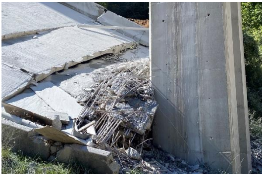
Figura 137 Vano 1. Mamparo 2. Vista general exterior desde el lateral derecho. A destacar el importante nivel de daño.
