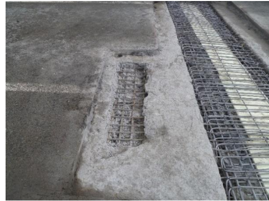
Figura 50 Detalle de hormigón degradado sobre cabeza de mamparos y frente de losa en 2013. Fuente: COPASA
