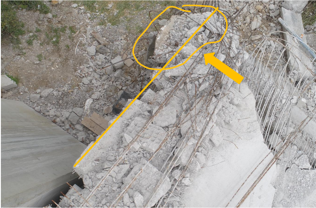
Figura 195 Vano 3. Mamparo 2. Vista general exterior superior derecha del mamparo. Pérdida de alineación de la zona del alma.
