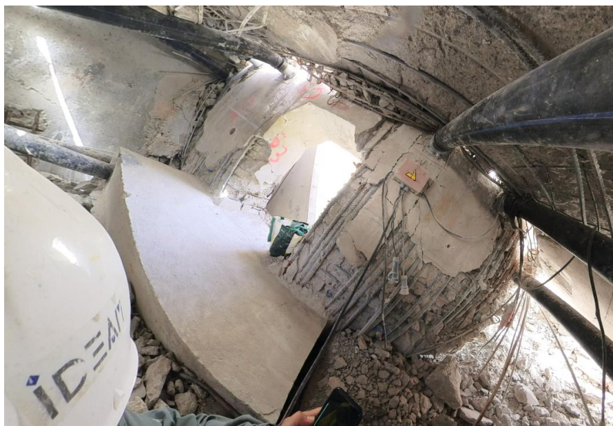
Figura 183 Vano 3. Mamparo 2. Vista general interior. Desprendimiento del hormigón del recubrimiento interior, más acusado en su lateral derecho. Tacón interior de refuerzo sin daños relevantes.
