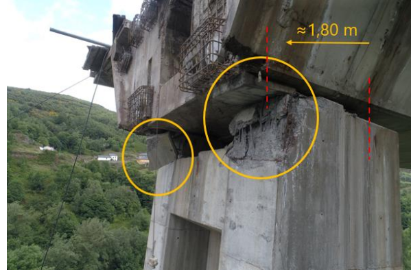
Figura 285 Detalle de cabeza de pila P2 tras colapso de vano V3, en donde claramente se observa el movimiento en cabeza de pila del orden de 1,80m.
