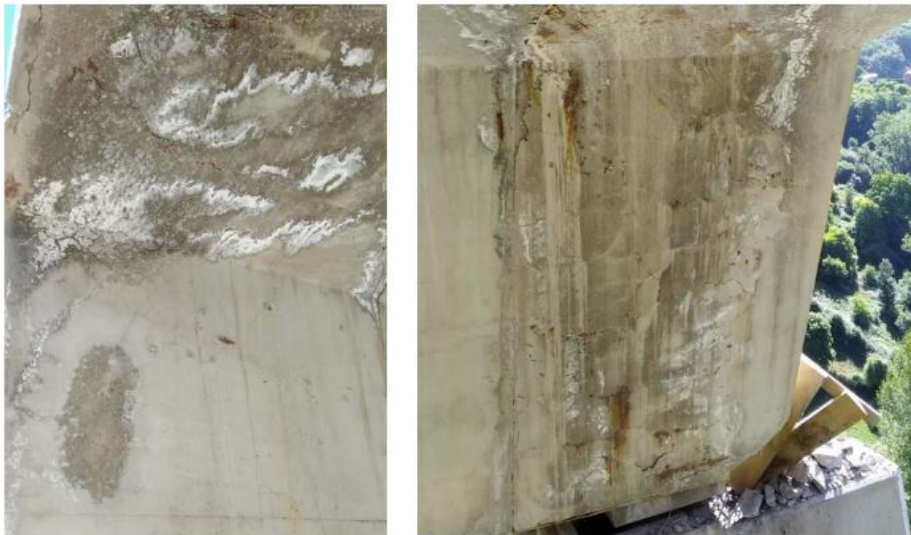
Figura 114 Cara exterior de mamparo 1. Daños durables y fisuración superficial en la dovela de mamparo. Fuente: Intemac
