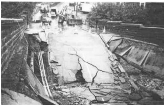
Figura 31 Colapso del puente Ynys-Y-Gwas en Inglaterra (1985) por corrosión del pretensado interior.
