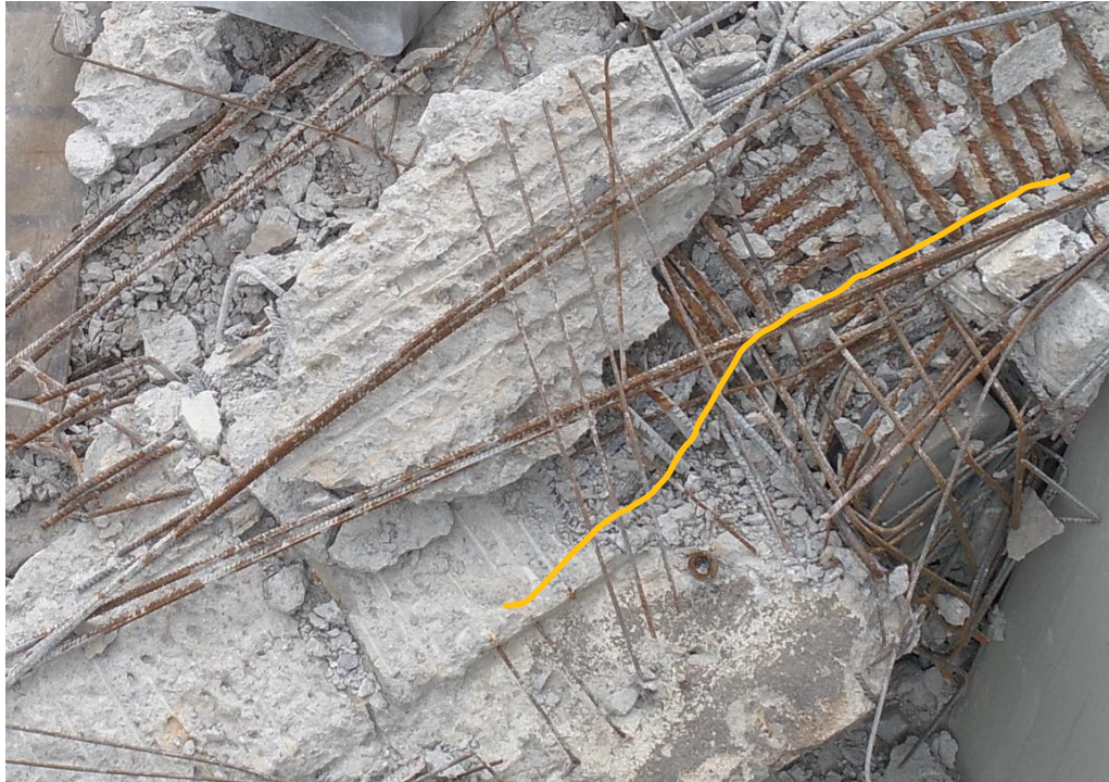
Figura 151 Vano 1. Mamparo 2. Detalle de zona donde se produce la pérdida de alineación del mamparo, claramente marcada en la traza de la armadura transversal superior.
