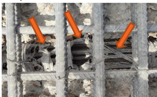
Figura 24 Ejemplo de pretensado interior con cable roto por corrosión. A ausencia de lechada
