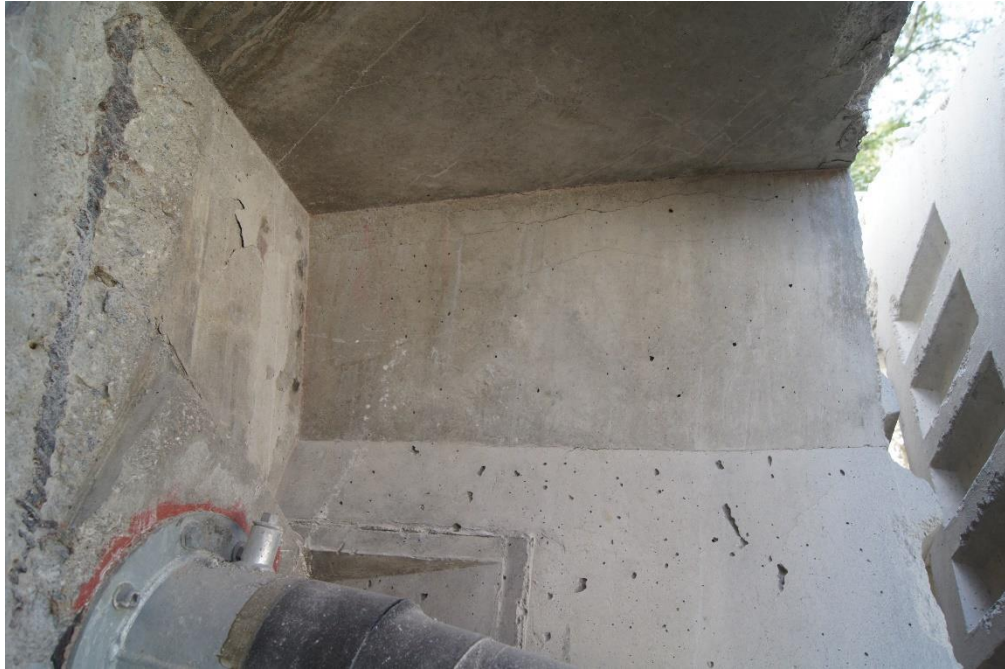
Figura 161 Vano 2. Mamparo 1. Vista general interior lateral izquierdo. Fisuras horizontales en la unión ala-alma a la salida del mamparo. Progresión a lo largo de la siguiente dovela, inclinándose 45° de abajo-arriba.
