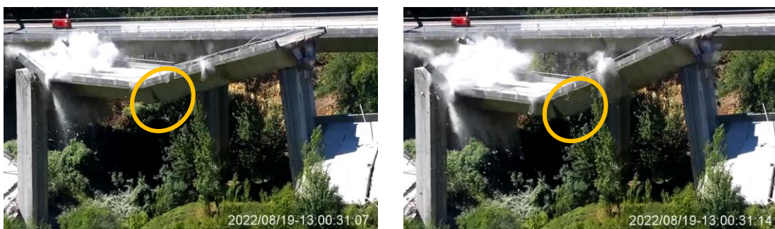
Figura 125 Apertura notable de junta entre dovelas. Fuente imagen: DGT
