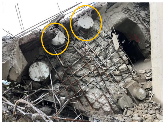
Figura 288 Vano V3 colapsado, mamparo Coruña (P3). Zona superior "estallada". Paso de hombre y esquina inferior con cierta integridad. Penetración de placas de pretensado en mamparo
