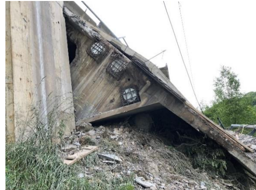
Figura 105 Vista general de mamparo lado Madrid del vano V3 colapsado. Aparente integridad física.
