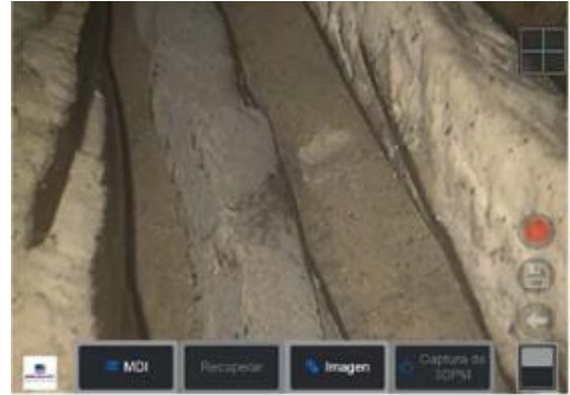
Figura 37 Tendón con deficiente inyección de vainas. Cordones desnudos y con corrosión. Fuente: Freyssinet
