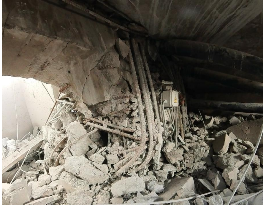
Figura 140 Vano 1. Mamparo 2. Vista general interior lateral derecho. Armaduras principales del mamparo descubiertas, las cuales presentan una gran deformación de su parte inferior hacia el interior del vano.
