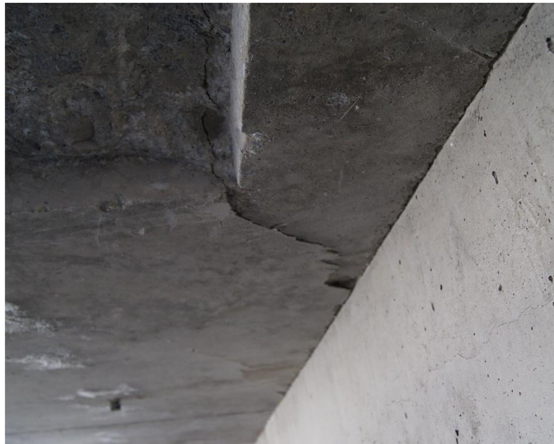
Figura 160 Vano 2. Mamparo 1. Detalle de progresión de trazado de la fisura anterior.
