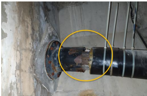
Figura 78 Vaina con cables al descubierto y vaina retraída unos centímetros respecto del tubo de salida del mamparo.
