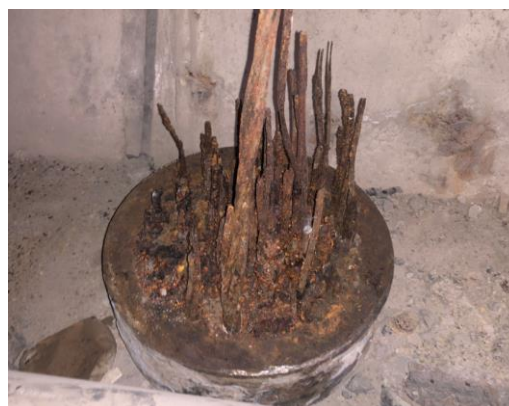
Figura 249 Vista general de bloque de cuñas tras retirada de cable roto sin tensión. Destacar el avanzado estado de corrosión de la práctica totalidad de los torones.
