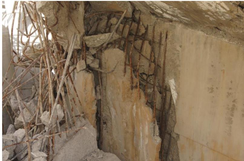
Figura 200 Vano 3. Mamparo 2. Cara lateral izquierda de mamparo y dovela anterior, D15. Rotura de alma, con formación de una cierta delaminación o plano de rotura, ejando ver las armaduras a la vista y con claros síntomas de corrosión.
