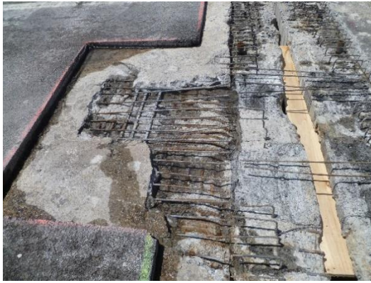
Figura 262 Detalle de losa de continuidad con daños sobre mamparos y cara superior de losa en 2013. Fuente: COPASA
