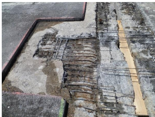
Figura 91 Detalle de losa de continuidad con daños sobre mamparos y cara superior de de losa en 2013. Fuente: COPASA
