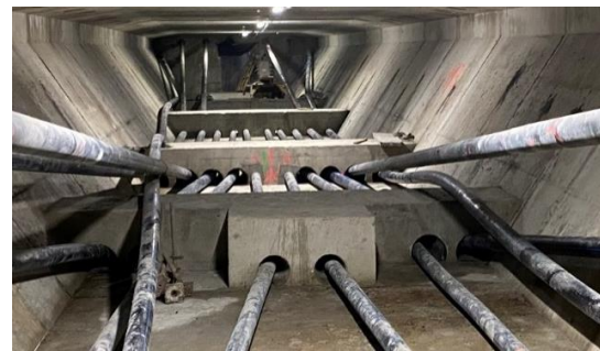
Figura 90 Detalle de tacón de desvío en desviadores extremos ejecutados para implementar los cables de refuerzo
