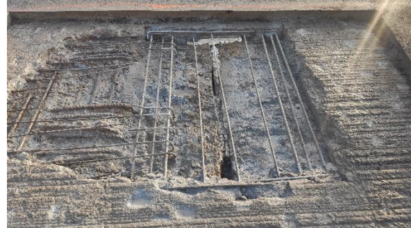
Figura 56 Vista de zona de losa dañada tras saneo del hormigón degradado. Avance del nivel de deterioro. Mayor corrosión de armaduras. Fuente: COPASA
