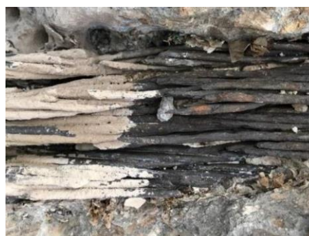
Figura 25 Ejemplo de pretensado interior con torones rotos por corrosión. A ausencia de lechada
