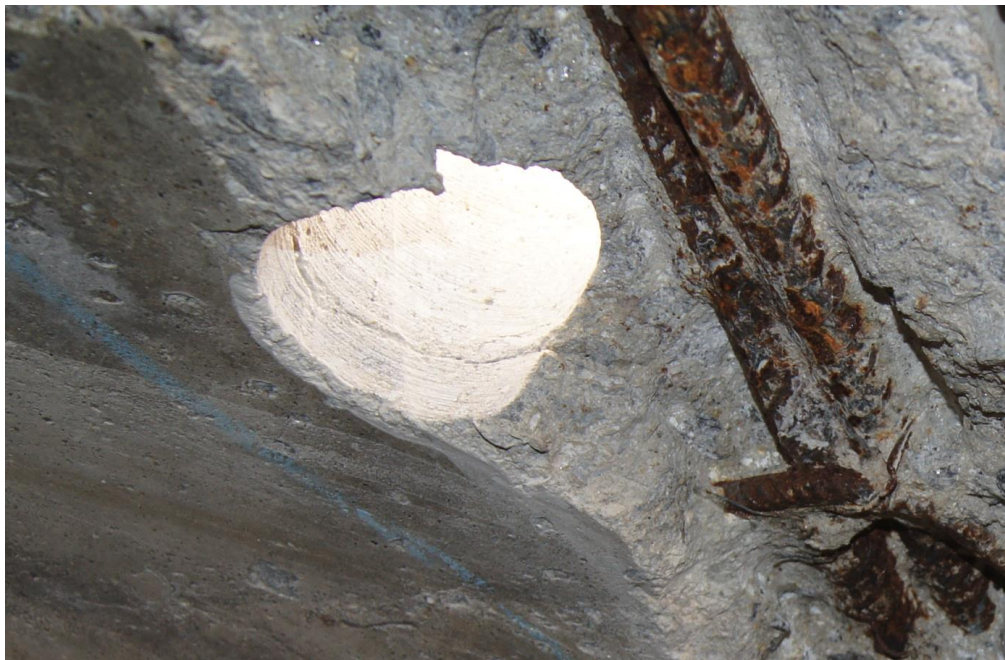
Figura 176 Fisura horizontal en interior de testigo.
