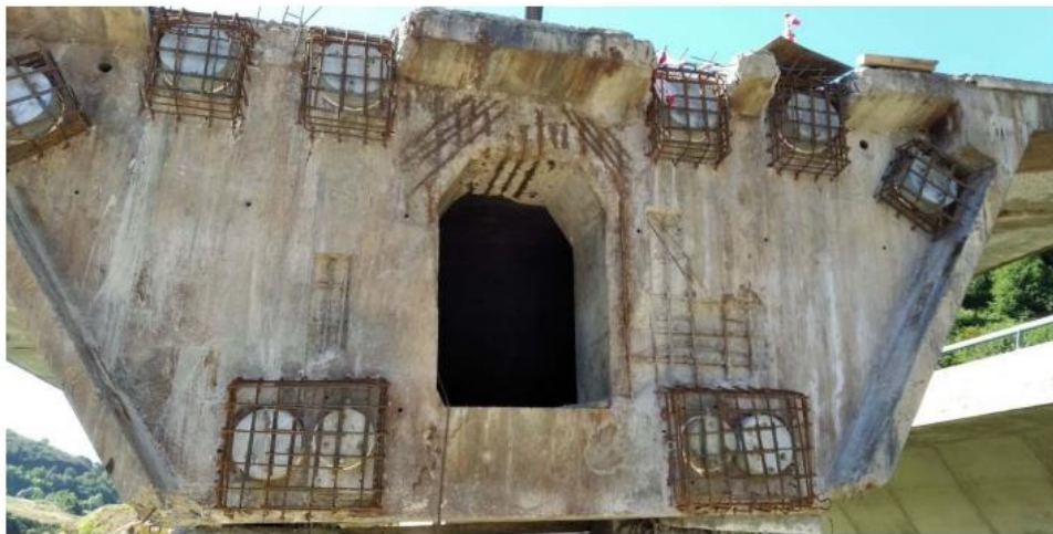
Figura 111 Vista general de mamparo 2 del vano 2. Daños durables en entorno al paso de hombre y por encima de los anclajes inferiores del pretensado. Fuente: Intemac
