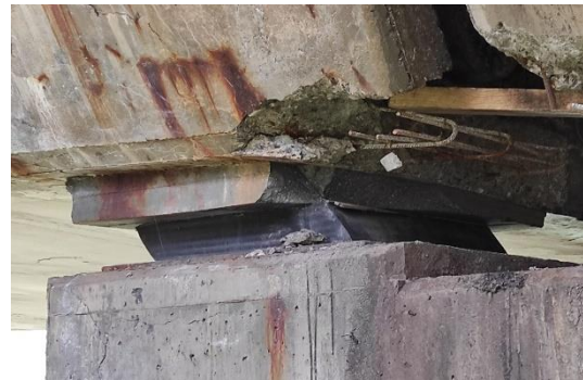
Figura 69 Deformación y despegue. Rotura de meseta (Viaducto grande, Pila 2, Apoyo Coruña-Izquierdo)
