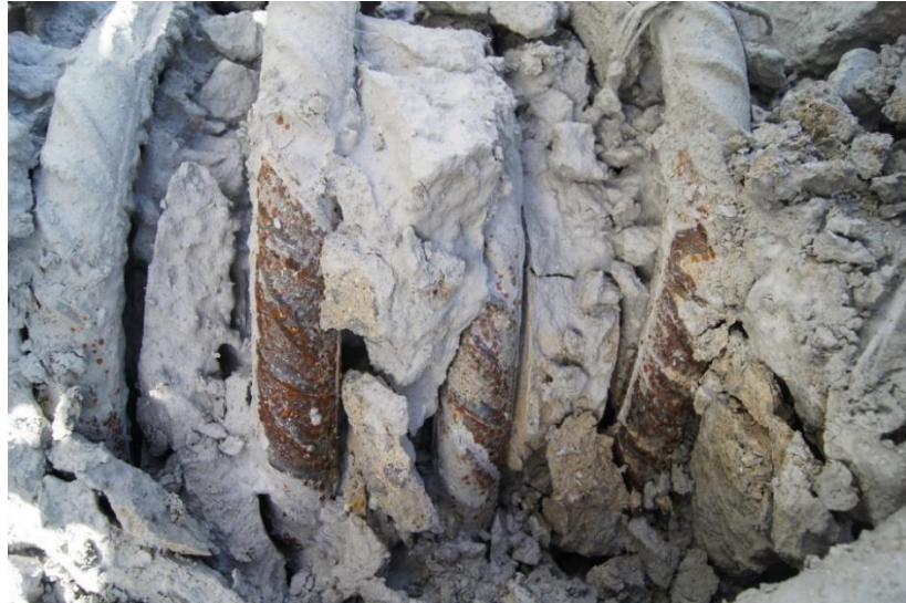
Figura 153 Vano 1. Mamparo 2. Detalle de frontal de nudo en zona de salida de mamparo (ver esquema e imagen superior). Hormigón interior aparentemente “machacado” y “pulverizado”, sin apenas poder distinguir entre la pasta del cemento y los áridos del hormigón. En la imagen superior se incluye la vista general del nudo previo a la retirada de los fragmentos exteriores del hormigón.
