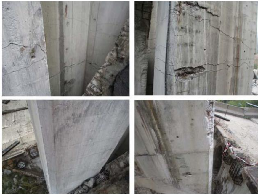
Figura 120 Detalle de alzado de pila P2 tras la demolición del vano V2. Presencia de fisuras/grietas en el alzado de pila a unos 3 m sobre el terreno fruto del impacto del vano V2 en su caída. Fuente: Intemac
