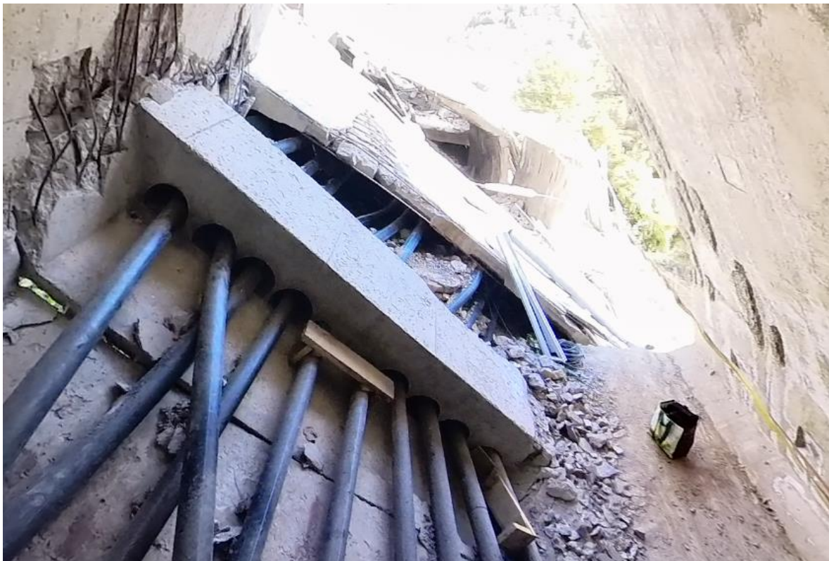
Figura 203 Vano 3. Desviador D7. Vista general. Aparente integridad del mismo, salvo en su lateral derecho que se encuentra "arrancado" del alma, por idéntico motivo que en el caso anterior.
