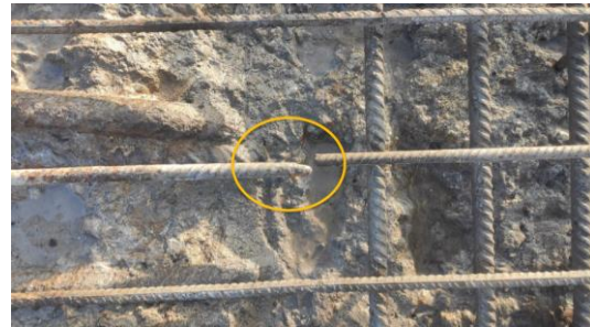
Figura 4 Detalle de rotura de armadura por corrosión por cloruros en detalle de losa de continuidad. Fuente: COPASA
