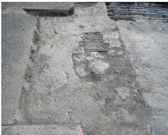
Figura 264 Hormigón degradado sobre la cabeza de mamparos en 2013. Fuente: COPASA
