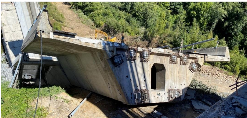
Figura 132 Vano 1. Mamparo 1. Vista general. Aparente integridad del mismo tras colapso.
