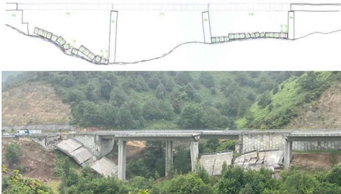
Figura 130 Croquis e imagen del estado de los vanos V1 y V3 tras los colapsos. Fuente: Intemac
