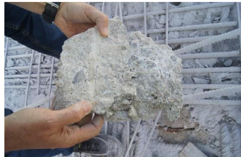
Figura 167 Vano 2. Mamparo 1. Fragmento de hormigón en parte superior de junta fría. Ausencia de árido "cosiendo" la interfase de la junta.
