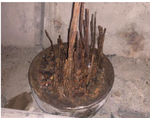
Figura 13 Vista general de bloque de cuñas tras retirada de cable roto sin tensión. Destacar el avanzado estado de corrosión de la práctica totalidad de los torones.
