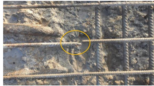
Figura 279 Detalle de rotura de armadura por corrosión por cloruros en detalle de losa de continuidad. Fuente: COPASA 2020
