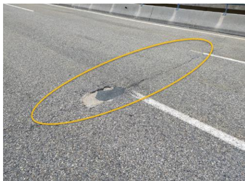
Figura 244 Fisuración de losa de continuidad y degradación del firme
