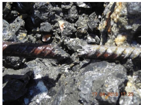
Figura 52 Detalle de armaduras rotas por corrosión detectada durante los trabajos de reparación del año 2013. Fuente: COPASA
