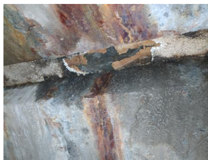
Figura 277 Detalle de cara inferior de losa de continuidad con claros indicios de circulación de agua y corrosión de las armaduras.
