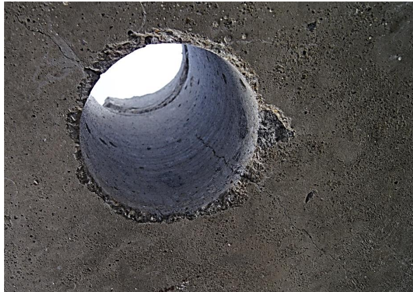
Figura 163 Vano 2. Mamparo 1. Fisura de cara inferior de losa interceptada por perforación de testigo.
