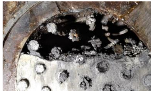
Figura 41 Extremo de tendón en zona de tromplaca. Lechada incompleta, de mala consistencia. Corrosión y rotura de cables. Fuente: Freyssinet
