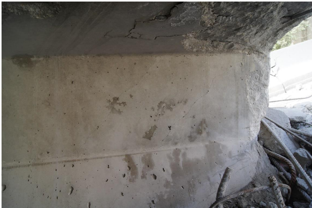
Figura 162 Vano 2. Mamparo 1. Vista general interior lateral izquierdo. Detalle de fisuras en dovela D2, donde se observa la fisuración a 45° anteriormente citada. Dicho patrón de fisuración se reproduce de forma simétrica en el lateral derecho.
