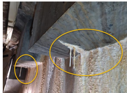
Figura 243 Fisuración de cajetín de sellado del pretensado con circulación de agua y presencia de deposiciones de carbonatos en forma de estalactitas.
