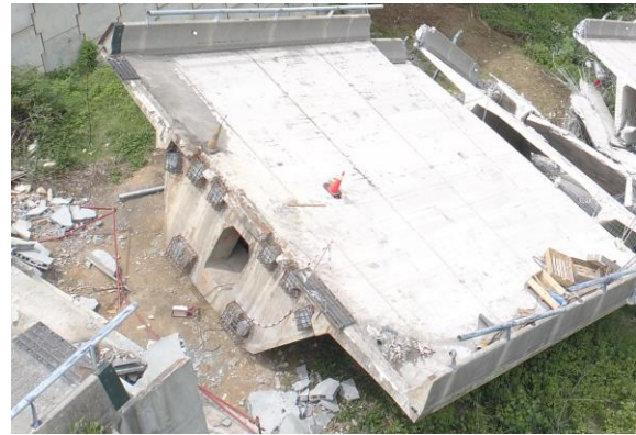
Figura 108 Mamparo del lado Madrid del vano 1 tras su colapso, con aparente integridad.
