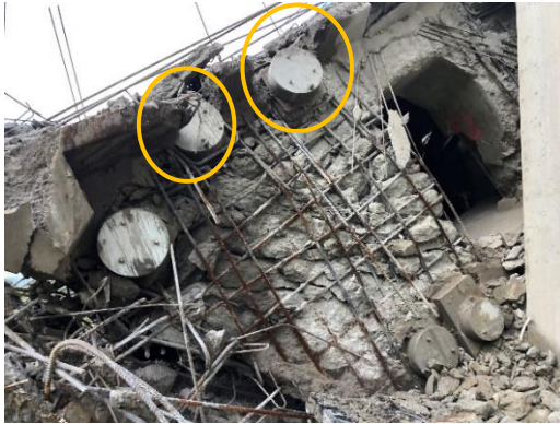
Figura 104 Vano V3 colapsado, mamparo Coruña (P3). Zona superior "estallada". Paso de hombre y esquina inferior con cierta integridad. Penetración de placas de pretensado en mamparo
