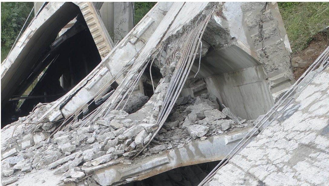
Figura 208 Vano 3. Detalle de rotura alma-losa izquierda de la dovela D11. Delaminación de armadura superior de losa.
