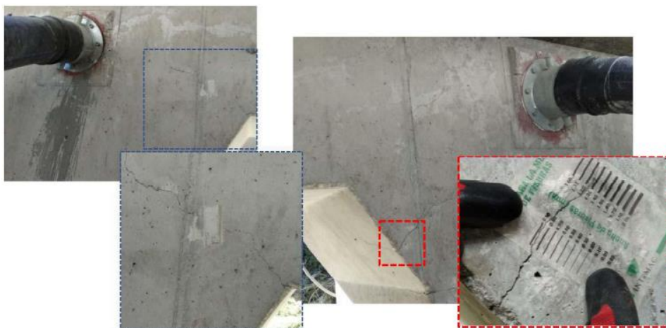
Figura 112 Toma de datos de mamparos. Fisuración radial entorno a pasos de hombre. Fuente: Intemac
