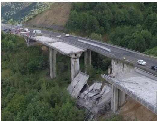
Figura 102 Vista de la estructura tras el colapso del vano 3
