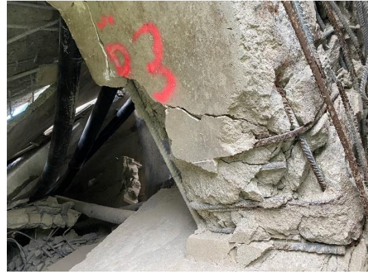
Figura 185 Vano 3. Mamparo 2. Vista lateral izquierda del mamparo en la zona del paso de hombre. Ligero aumento de espesor con el hormigón completamente fragmentado en su interior
