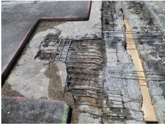
Figura 49 Detalle de losa de continuidad con daños sobre mamparos y cara superior de losa en 2013. Fuente: COPASA
