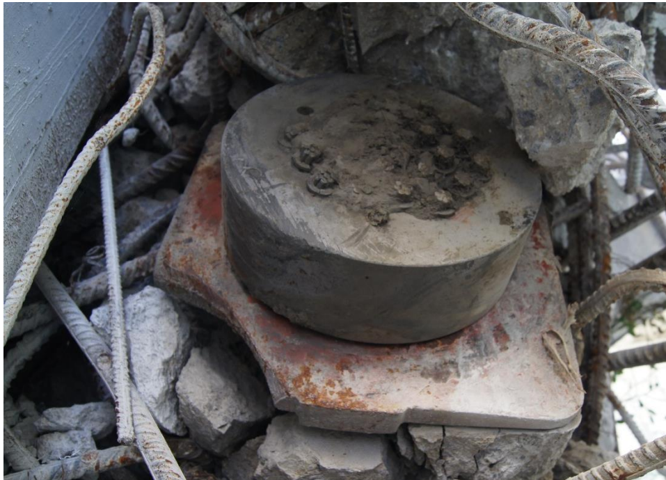
Figura 148 Vano 1. Mamparo 2. Vista frontal de la placa de anclaje del alma izquierda. Rotura de esquina de placa y del hormigón bajo el bloque de la placa de asiento.
