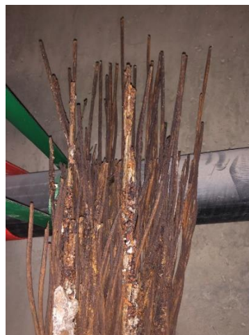
Figura 86 Detalle de torones totalmente rotos, deshilachados y con pérdidas significativas de material base por corrosión.
