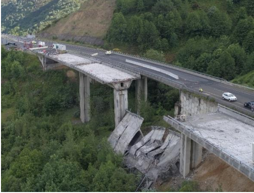
Figura 284 Vista de la estructura tras el colapso del vano 3
