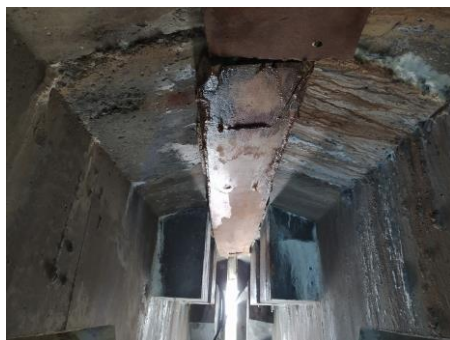
Figura 5 Detalle de cara inferior de losa de continuidad, con presencia de agua en el momento de la inspección.
