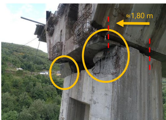
Figura 118 Detalle de desplazamiento de pila P2 respecto al eje de apoyo del vano V2.
