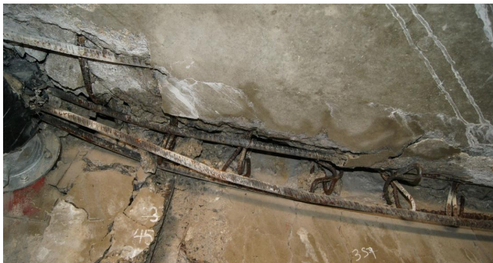
Figura 144 Vano 1. Mamparo 2. Detalle interior de la parte superior del paso de hombre en donde se puede observar la ausencia/rotura del tramo de sección cajón de la dovela D16, al igual que un cierto nivel de daño, posiblemente por golpe/impacto de la propia dovela D15 contra el mamparo.
