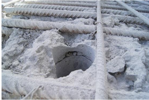
Figura 168 Vano 2. Mamparo 1. Detalle de plano de delaminación producido por la junta fría en el paramento interior de uno de los testigos extraídos.
