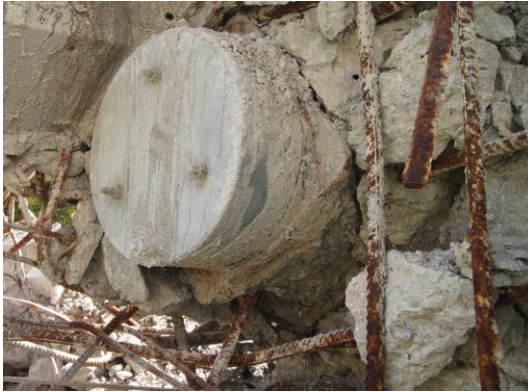
Figura 191 Vano 3. Mamparo 2. Detalle de tendón de pretensado del alma derecha. Integridad del bloque de hormigón zunchado por la introducción de la carga del pretensado.
