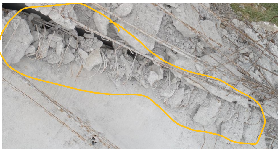
Figura 199 Vano 3. Mamparo 2. Vista general exterior superior del mamparo. Fragmentos de hormigón pendientes de identificar si proceden de la dovela D15 o D16.
