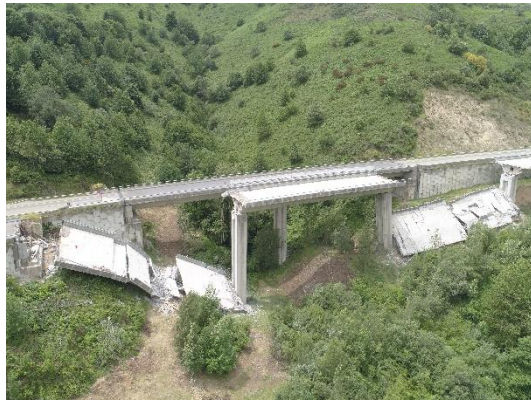
Figura 107 Vista general de la estructura tras el colapso del vano 1
