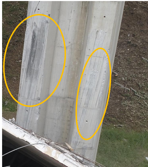
Figura 117 Vista frontal de la pila P1. Marcas de roce de cajón durante caída y, en negro del roce de los aparatos de apoyo.
