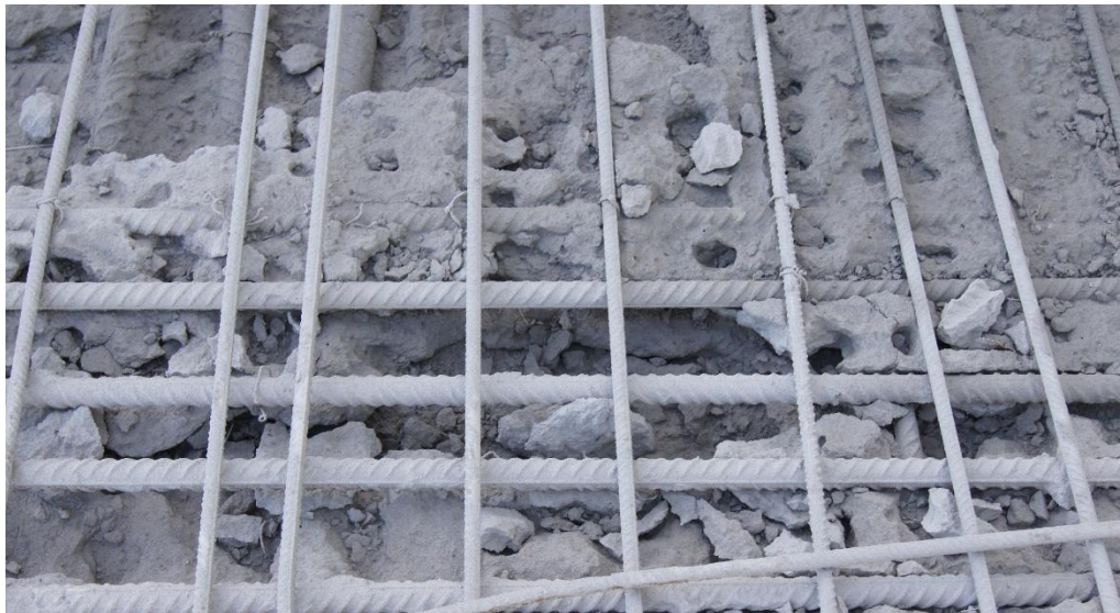
Figura 165 Vano 2. Mamparo 1. Vista general exterior del mamparo donde se advierte la junta fría detectada a unos 10-11 cm estimados de la cara superior de losa.
