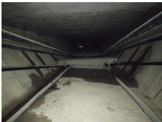
Figura 246 Vista general de interior de cajón en donde se observa claramente la presencia de agua en su interior, así como las manchas y humedades en las almas, fruto de la entrada de agua a través de los pasa tubos de losa.
