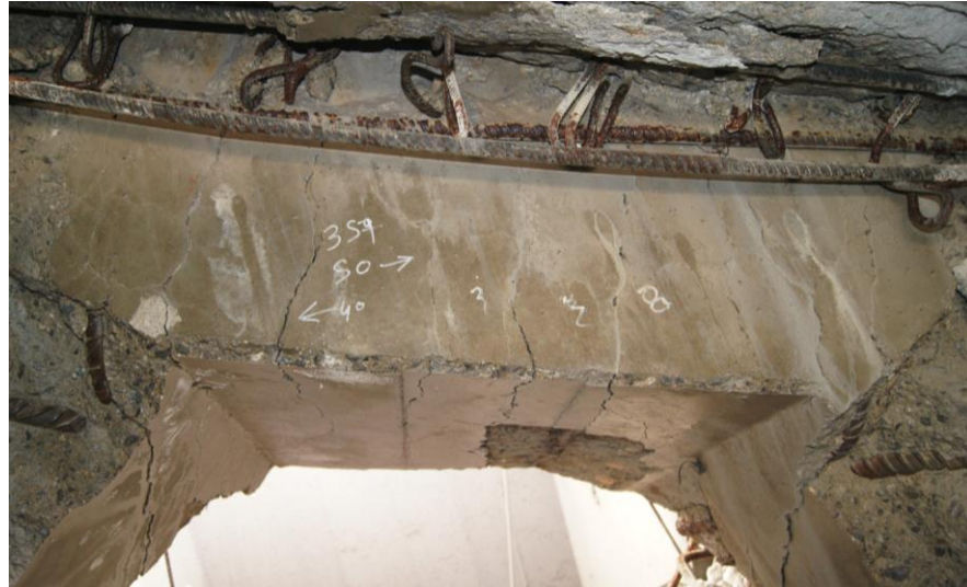
Figura 142 Vano 1. Mamparo 2. Vista general interior de la parte superior del paso de hombre. Fisuración de hasta 2 mm de apertura, producida seguramente por flexión de eje vertical del mamparo. Obsérvese también, en la parte superior de la imagen, el contacto directo entre la dovela D15 y el mamparo (D16), lo que pone de manifiesto la ausencia/rotura del tramo de sección cajón de la dovela D16.
