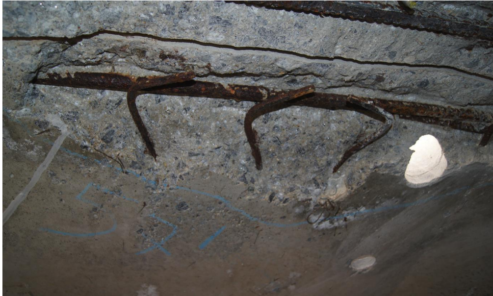
Figura 175 Detalle de armadura longitudinal de losa de dovela con claros síntomas de corrosión y, al mismo tiempo, la patilla de anclaje aparece dispuesta el horizontal en vez de en vertical.
