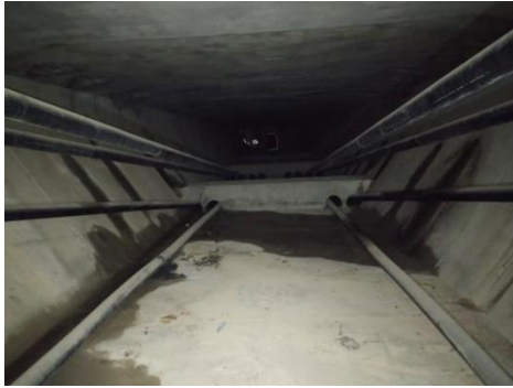
Figura 45 Vista general del cajón en donde se observa claramente la presencia de agua en su interior, así como las manchas y humedades en almas, fruto de la entreda de agua a través de los agujeros/pasatubos de cuelgue de las dovelas durante la construcción
