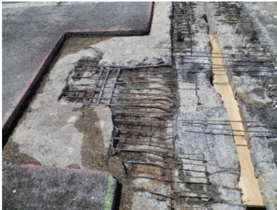
Figura 302 Detalle de losa de continuidad con daños sobre mamparos y cara superior de losa en 2013. Fuente: COPASA
