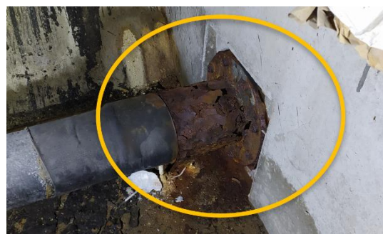
Figura 77 Significativa degradación de tubo metálico de salida de mamparo. Delaminación en forma de láminas ("hojaldre") del acero del tubo.
