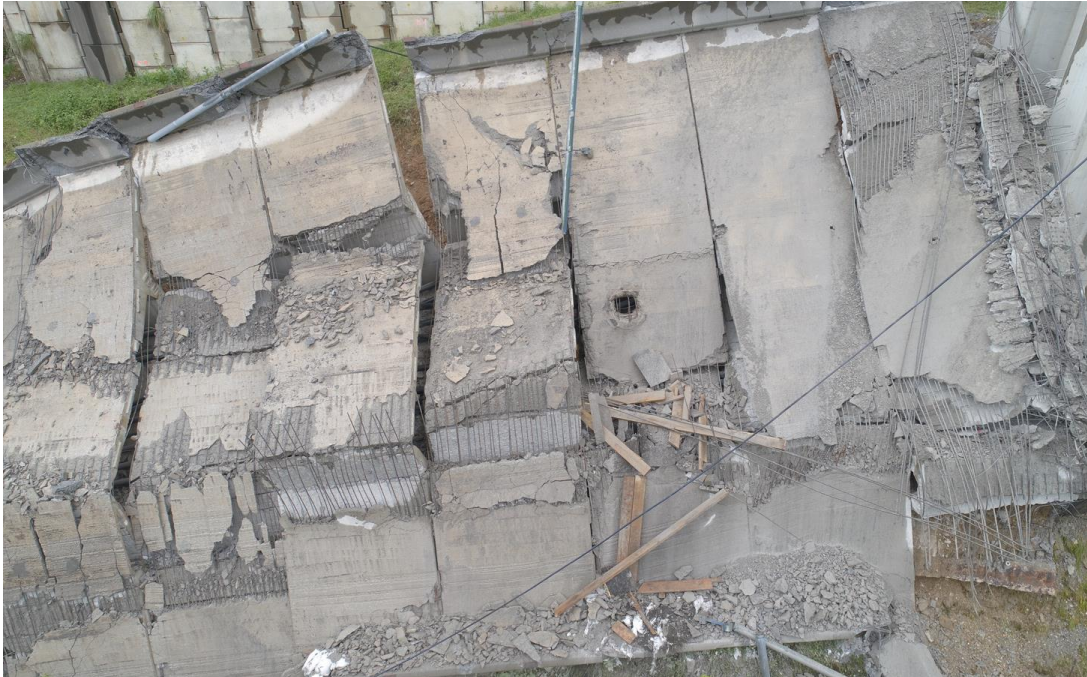
Figura 207 Vano 3. Vista general del exterior del tablero, desde la dovela D9 al mamparo 2. Claramente se observa un patrón de rotura con delaminación del hormigón.
