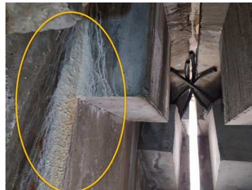
Figura 63 Circulación de agua con deposiciones blanquecinas en cajetines superiores de pretensado.
