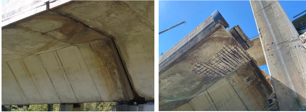
Figura 177 Vano 2. Mamparo 2. Vista exterior del lateral derecho. Comparación entre el estado previo a la demolición, fase de inspección inicial exterior de la estructura, y tras la caída. Clara magnificación y constatación del nivel de daños que manifestaba el tablero. Zona identificada y marcada a sanear y reparar en el Proyecto de Reparación.
