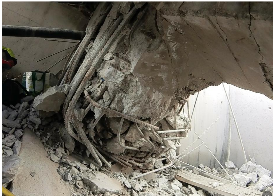
Figura 141 Vano 1. Mamparo 2. Vista general interior lateral izquierdo. Armaduras principales del mamparo descubiertas, las cuales presentan una gran deformación de su parte inferior hacia el interior del vano.
