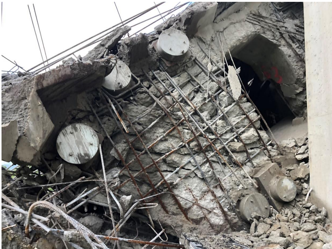
Figura 190 Vano 3. Mamparo 2. Vista general exterior del frente del mamparo. Fragmentación del hormigón interior del mamparo, especialmente en la zona correspondiente al lateral izquierdo del mismo, con una clara inclinación de los fragmentos a unos 45°. Área triangular inferior marcada por la parte inferior del paso del bloque de pretensado del alma con la cara inferior del paso de hombre con una cierta mayor integridad del hormigón. Sin daños o desórdenes aparentes en la zona de los anclajes inferiores.
