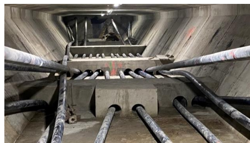
Figura 275 Detalle de tación de desvío en desviadores extremos ejecutados para implementar los cables de refuerzo
