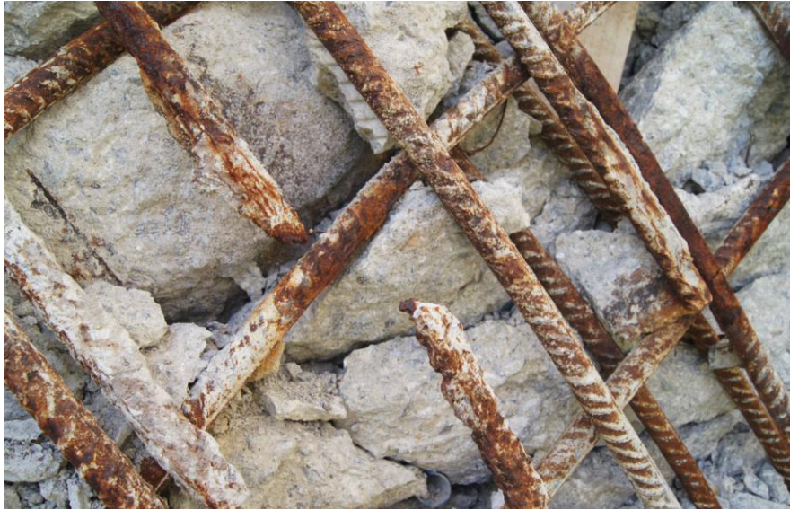
Figura 197 Vano 3. Mamparo 2. Vista general exterior del mamparo. Detalle de rotura de armadura por corrosión puntual localizada.
