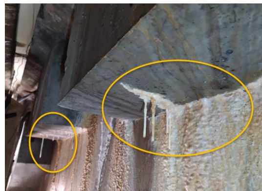
Figura 65 Fisuración de cajetín de sellado del pretensado con circulación de agua y presencia de deposiciones de carbonatos en forma de estalactitas.
