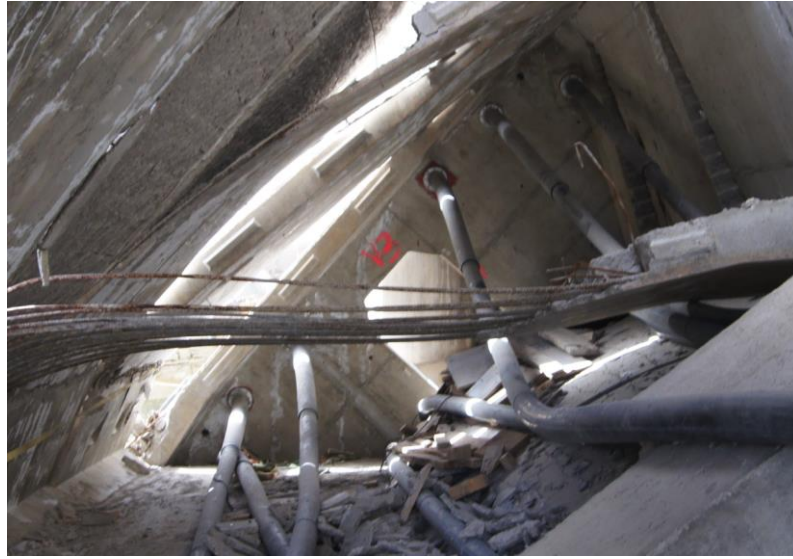
Figura 179 Vano 3. Mamparo 1. Vista general del interior interior del mamparo. Aparente integridad del mismo.
