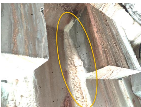
Figura 7 Circulación de agua con deposiciones blanquecinas.
