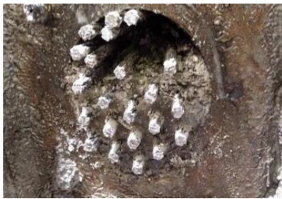
Figura 38 Extremo de tendón original tras retirada de bloque de cuñas. Lechada incompleta. Corrosión y rotura de cordones. Fuente: Freyssinet
