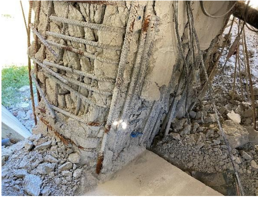
Figura 184 Vano 3. Mamparo 2. Vista lateral derecha del mamparo en la zona del paso de hombre. Ligero aumento de espesor con el hormigón completamente fragmentado en su interior.
