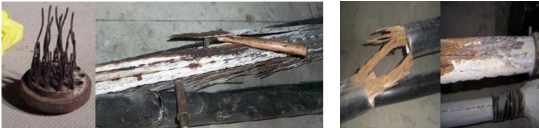
Figura 34 Ejemplos de cables rotos por corrosión en el puente de Mid-Bay (Florida) y en el puente de Verina-Enon (Virginia) a la izquierda y derecha respectivamente
