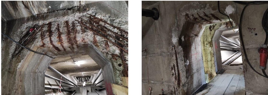
Figura 67 Desconchones con armadura en avanzado estado de corrosión en mamparos
