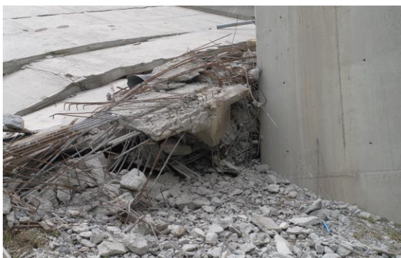
Figura 109 Mamparo del lado Coruña del vano 1 fuertemente "estallado" tras colapso de vano y efecto de la caída
