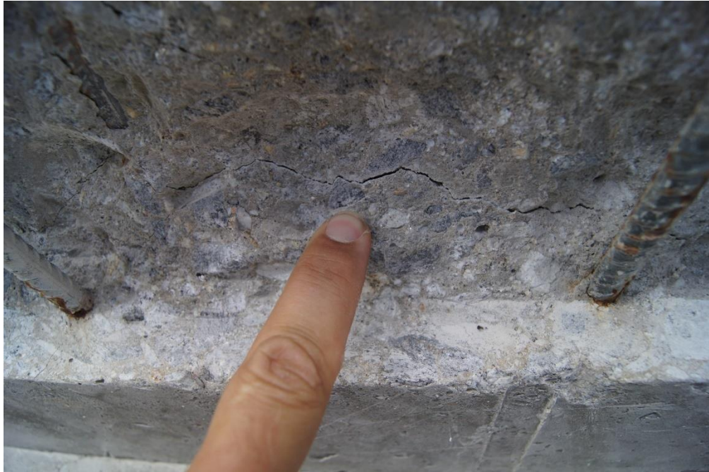
Figura 159 Vano 2. Mamparo 1. Detalle de fisura interior de trazado variable y próxima al encuentro del acartelamiento superior de losa y cara interior del mamparo.
