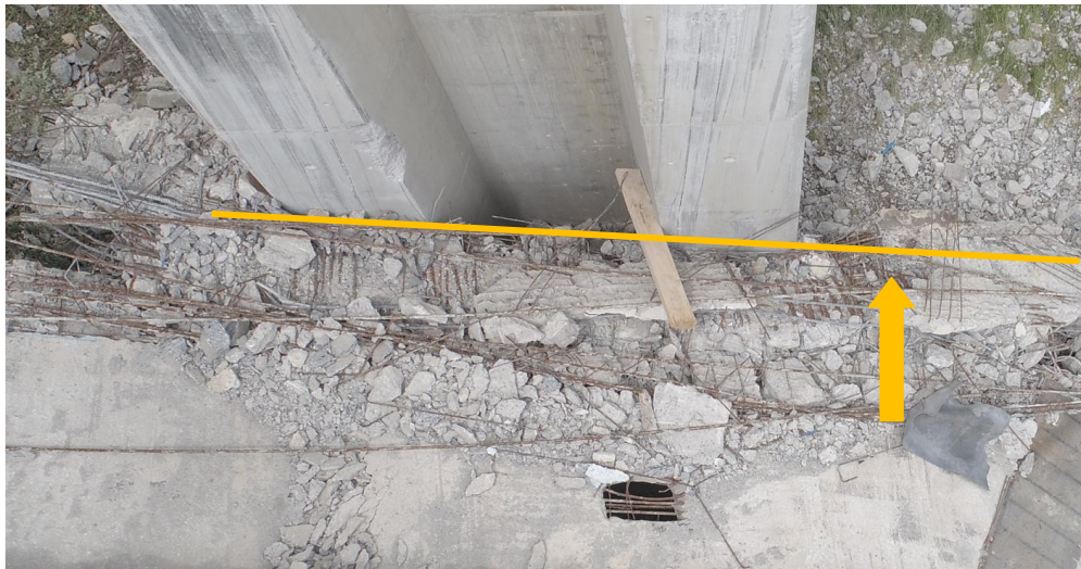
Figura 150 Vano 1. Mamparo 2. Vista superior de mamparo donde se aprecia la pérdida de alineación de la zona correspondiente al alma derecha.
