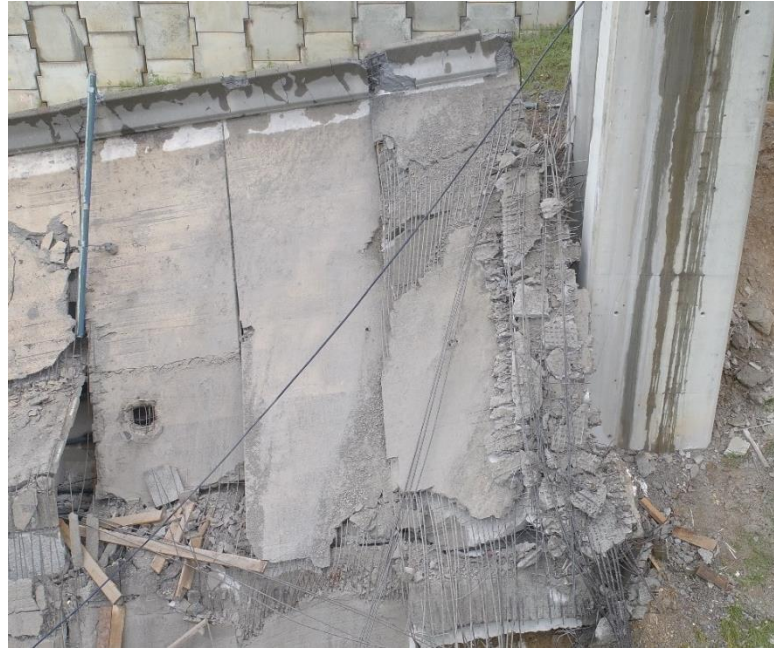
Figura 181 Vano 3. Mamparo 2. Vista general superior del mamparo y dovelas aledañas, a la izquierda de la imagen la pila P3.
