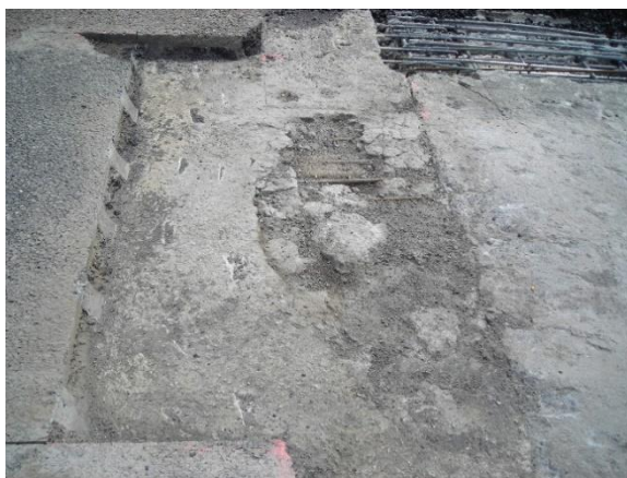
Figura 51 Hormigón degradado sobre la cabeza de mamparos en 2013. Fuente: COPASA
