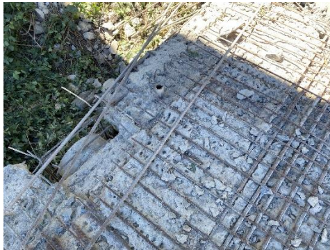
Figura 170 Vano 2. Mamparo 1. Cara superior de losa. Presencia de irregularidades superficiales en forma de "picotazos" producidos por la hidrodemolición, seguramente por la presencia de la junta fría.
