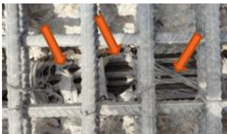
Figura 255 Ejemplo de pretensado interior con cable roto por corrosión. A ausencia de lechada
