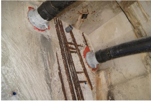
Figura 133 Vano 1. Mamparo 1. Vista interior del lateral izquierdo. Daños durables por corrosión de armaduras.
