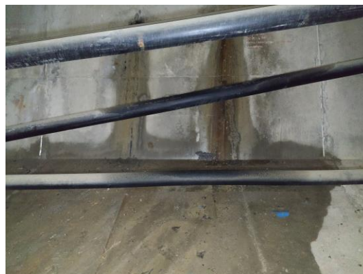
Figura 247 Detalle de humedades en almas de interior de cajón bajo tubos de cuelgue de dovelas.
