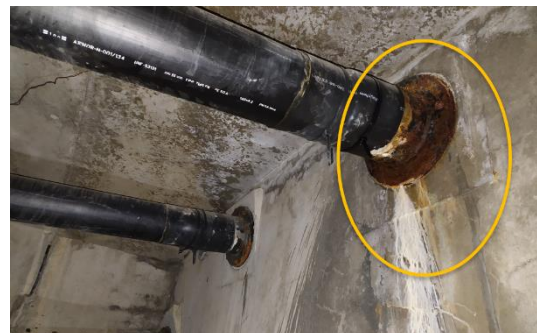
Figura 75 Ídem anterior. Nótese además la presencia circulación de agua con deposiciones blanquecinas bajo el tubo de salida del mamparo
