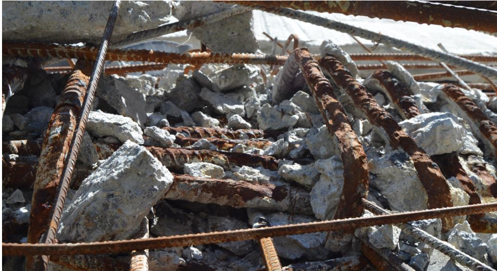
Figura 149 Vano 1. Mamparo 2. Vista superior mamparo sobre bloque de pretensado. Corrosión severa de amaduras, incluso con pérdida de corruga de barra Ø32 y pérdida de posición de barras.
