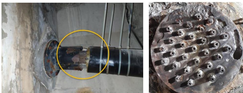
Figura 19. Estado de la vaina retraída sin protección de los cables (izq). Anclaje de pretensado con alambres deslizados (der.) (Fuente: [5]).
