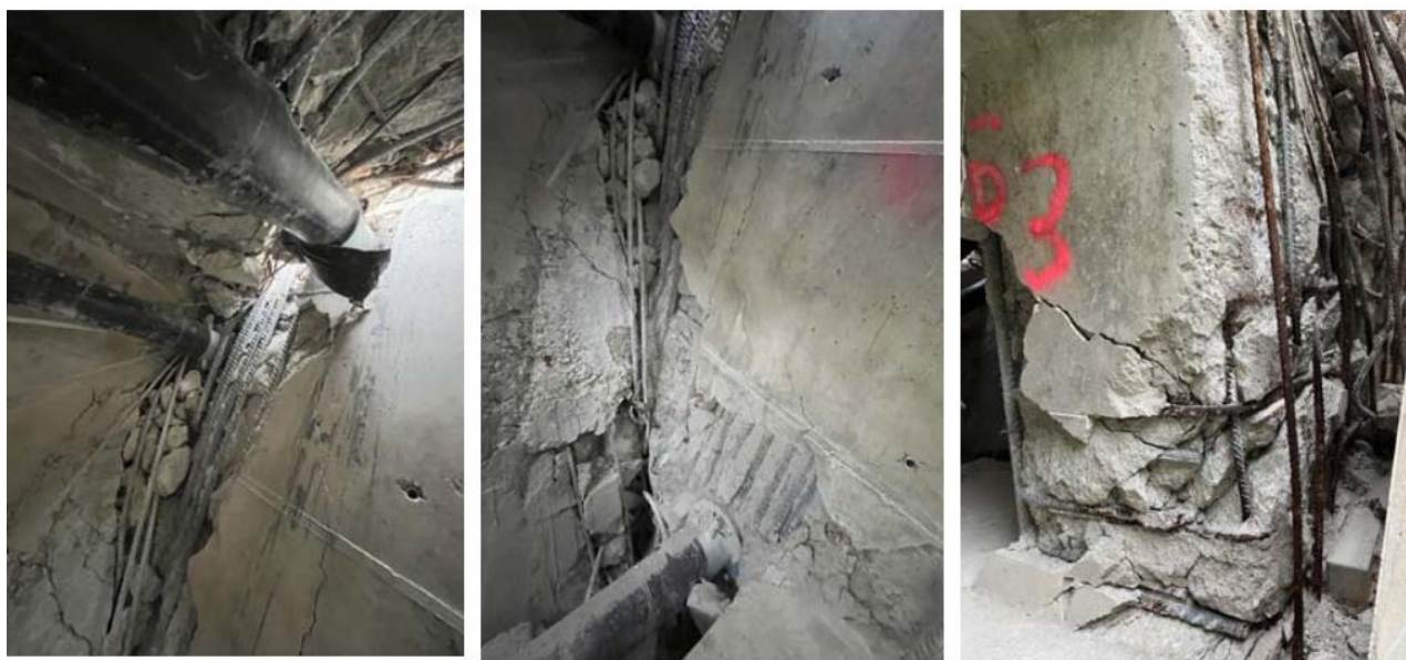
Figura 39. Mamparo de pila P3 del vano 3 del viaducto sentido A Coruña tras el colapso. Vistas interiores. (Fuente: [19])
