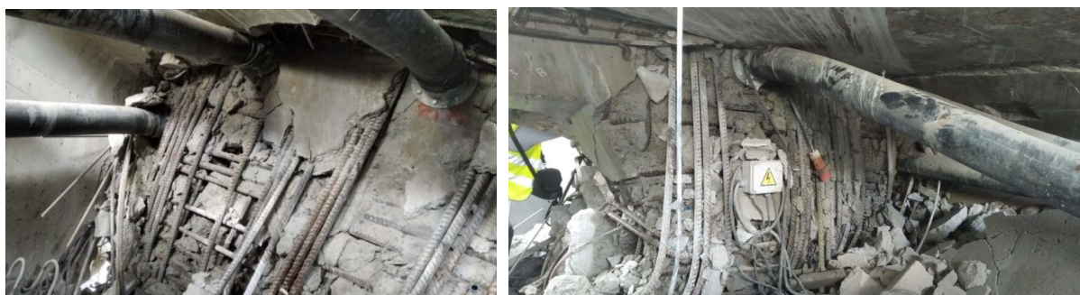
Figura 50. Mamparo de pila P1 del vano 1 del viaducto sentido A Coruña tras el colapso. Vista interior. (Fuente: [19])
