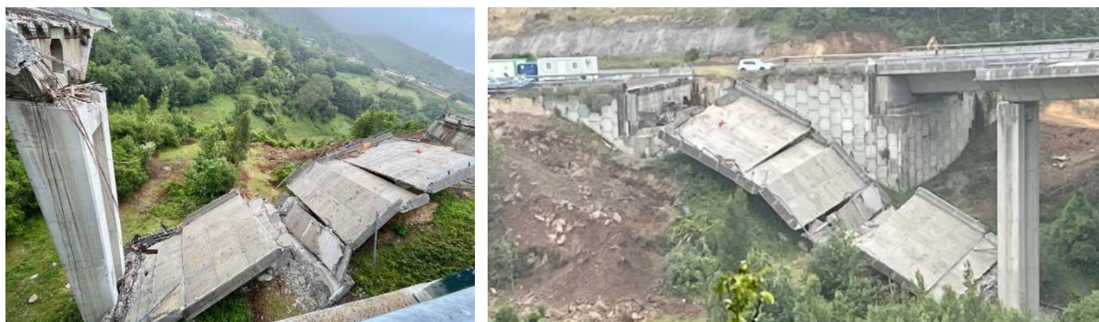
Figura 47. Situación del vano 1 del viaducto sentido A Coruña tras el colapso.
