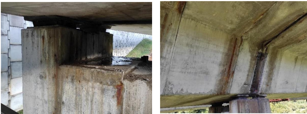
Figura 22. Daños durables en superficies exteriores. (Fuente: [5]).
