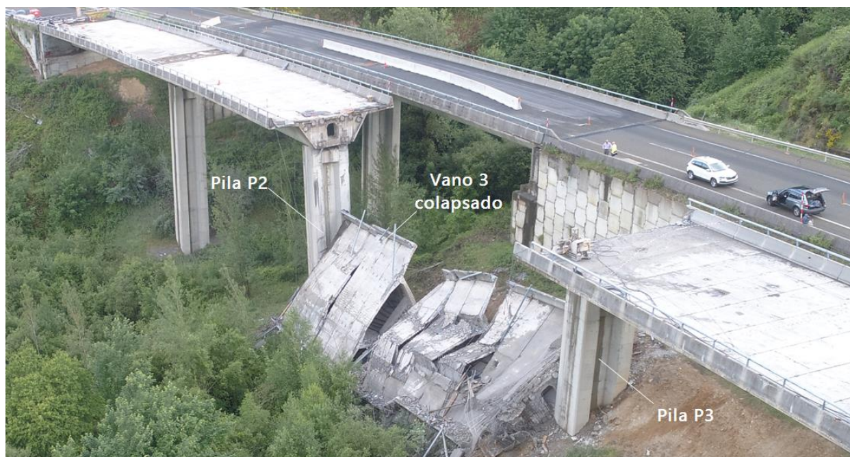
Figura 29. Situación del viaducto sentido A Coruña tras el colapso del vano 3. (Fuente: [7]. Elaboración propia).
