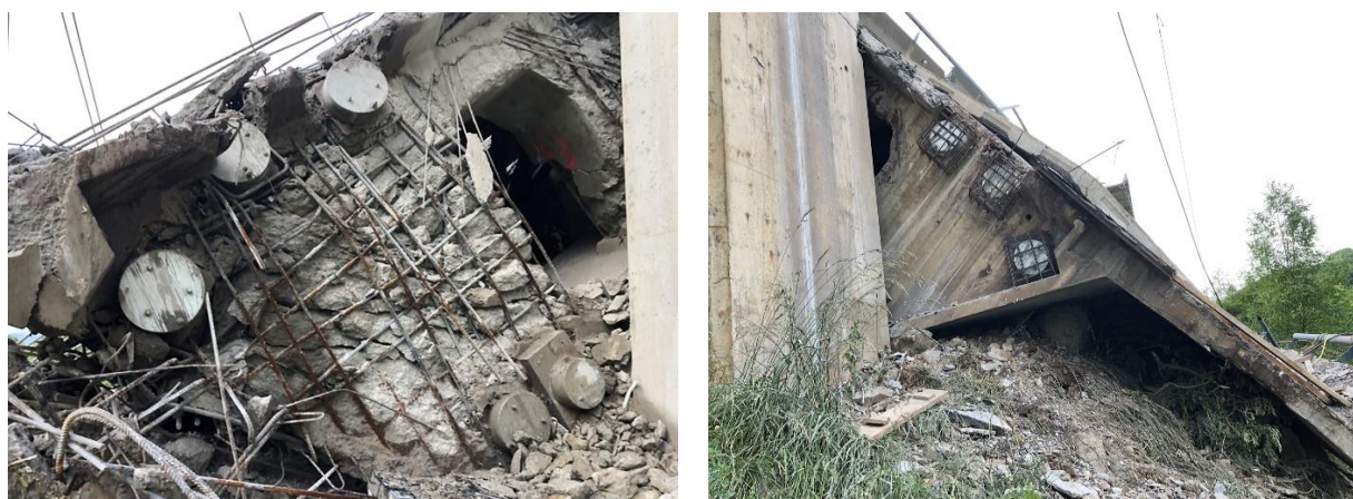
Figura 32. Dovela del mamparo de pila P3 (izq.) con elevado nivel de daños, en comparación con el mamparo de pila P2, aparentemente íntegro.
