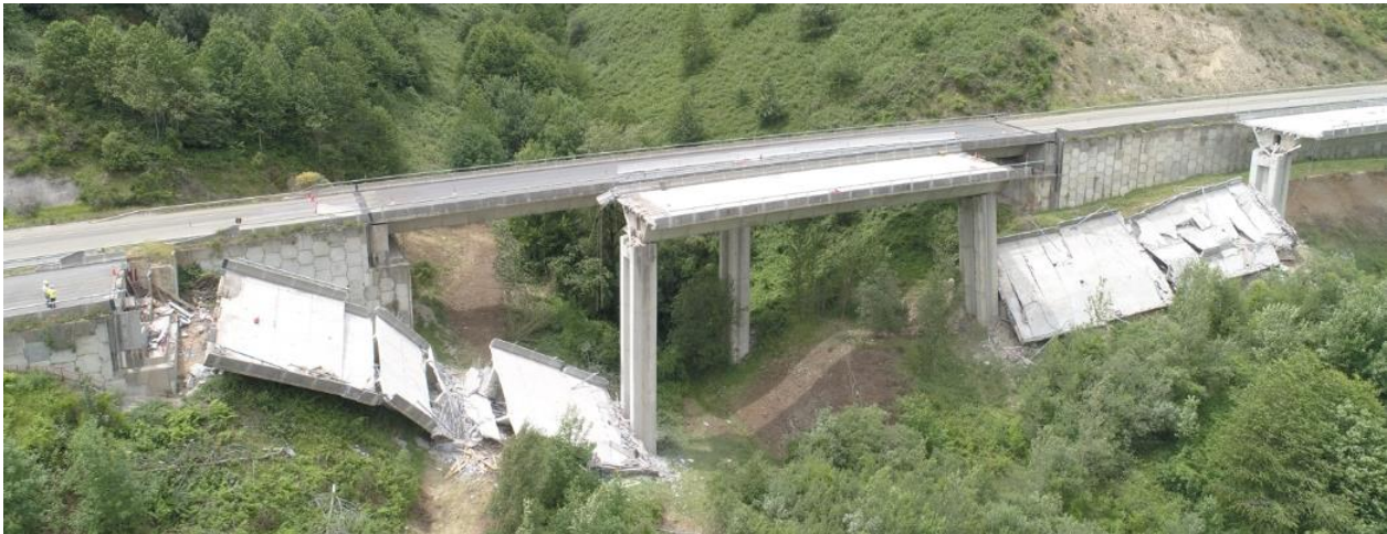
Figura 2. Estado final del viaducto de la calzada sentido A Coruña tras los colapsos del 7 y 16 de julio de 2022. (Fuente: [6])
