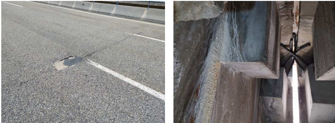
Figura 21. Daños en las losas de continuidad a nivel de plataforma (izq). Daños en cajetines de los anclajes de pretensado derivados de la falta de estanqueidad de la junta (der). (Fuente: [5]).
