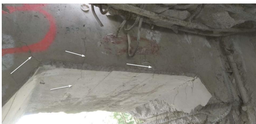
Figura 42. Mamparo de pila P3 del vano 3 del viaducto sentido A Coruña tras el colapso. Vista interior. (Fuente: [19])
