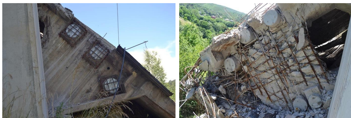
Figura 37. Mamparo de pila P2 (izq) y mamparo de pila P3 (der) del vano 3 del viaducto sentido A Coruña tras el colapso.
