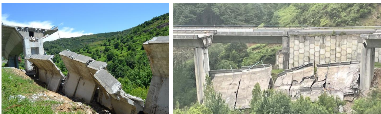
Figura 36. Situación del vano 3 del viaducto sentido A Coruña tras el colapso. Vista desde el muro de suelo reforzado (izq) y desde la carretera nacional.
