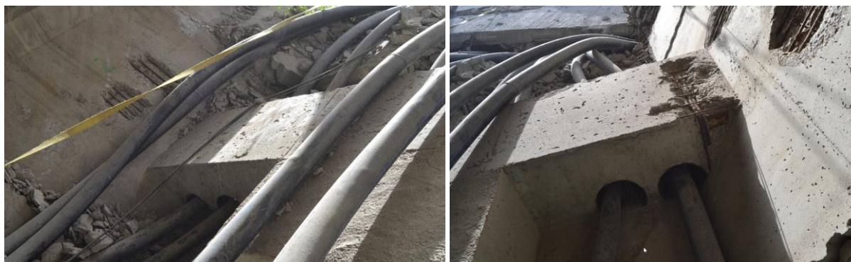
Figura 56. Mamparo de pila P3 del vano 3 del viaducto sentido A Coruña tras el colapso. Desviador. (Fuente: [19])
