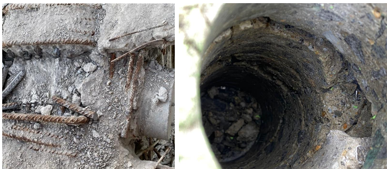
Figura 55. Mamparo de pila P1 del vano 1 del viaducto sentido A Coruña tras el colapso. Fracturación del hormigón. (Fuente: IDEAM)
