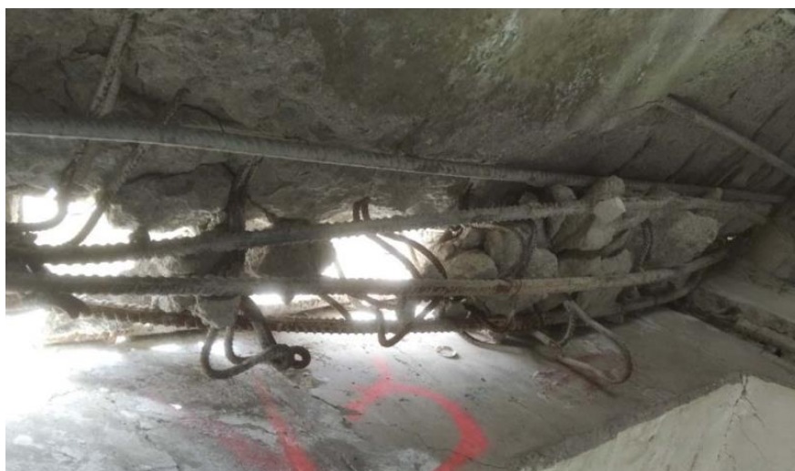
Figura 41. Mamparo de pila P3 del vano 3 del viaducto sentido A Coruña tras el colapso. Zona acartelada completamente rota.
