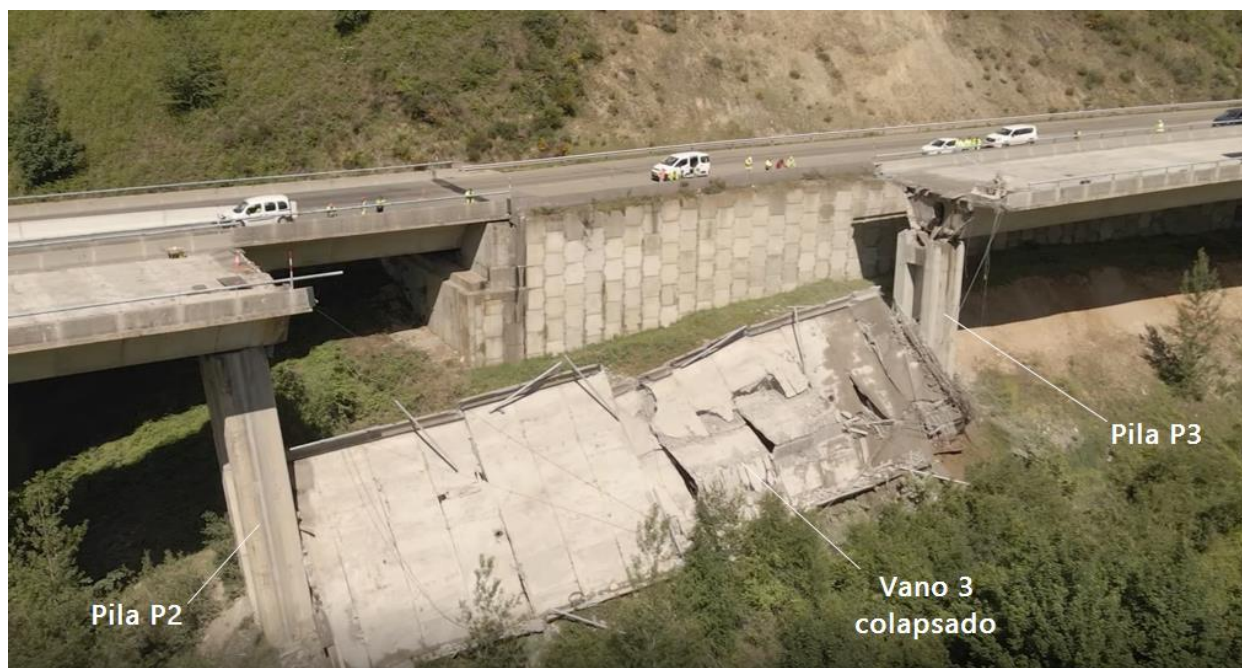
Figura 30. Situación del viaducto sentido A Coruña tras el colapso del vano 3. (Fuente: [7]. Elaboración propia).
