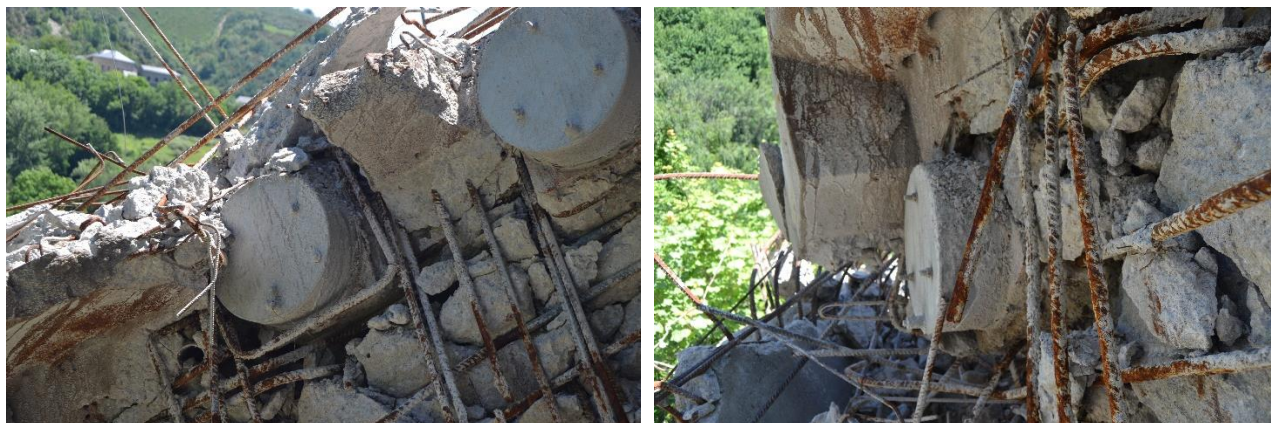
Figura 43. Mamparo de pila P3 del vano 3 del viaducto sentido A Coruña tras el colapso. Hundimiento de anclajes.
