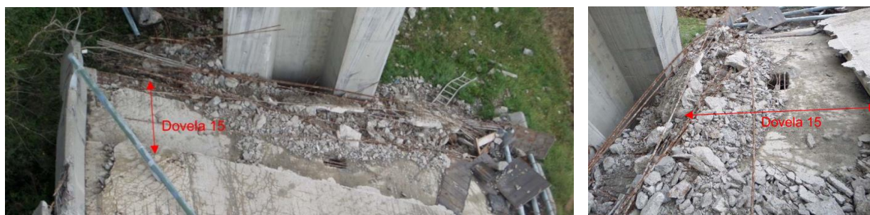
Figura 49. Mamparo de pila P1 del vano 1 del viaducto sentido A Coruña tras el colapso. Encabalgamiento de la dovela adyacente. (Fuente: [19])
