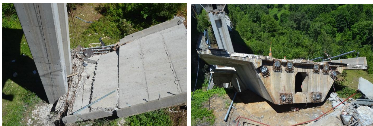
Figura 48. Mamparo de pila P1 (izq) y mamparo de estribo E1 (der) del vano 1 del viaducto sentido A Coruña tras el colapso.
