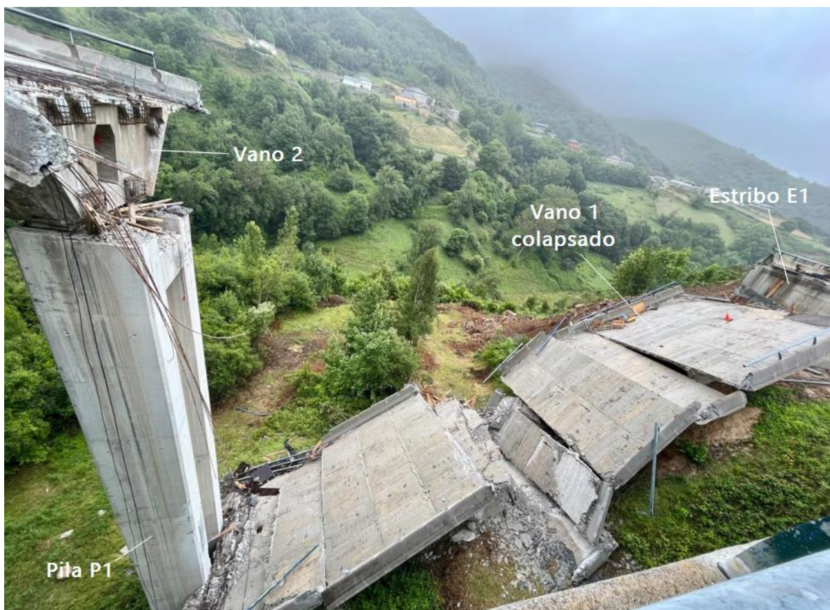
Figura 34. Situación del viaducto sentido A Coruña tras el colapso del vano 1. (Fuente: [8]. Elaboración propia).
