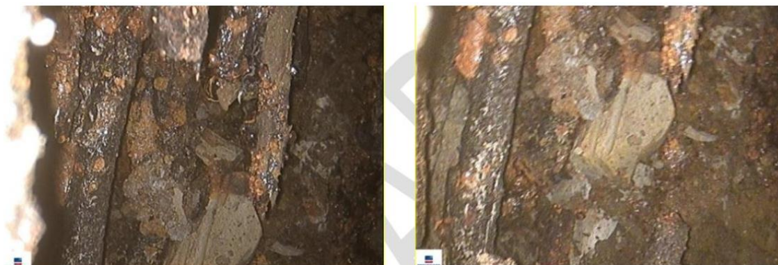
Figura 20. Imágenes de los cordones rotos por corrosión del cable de pretensado. (Fuente: [5]).
