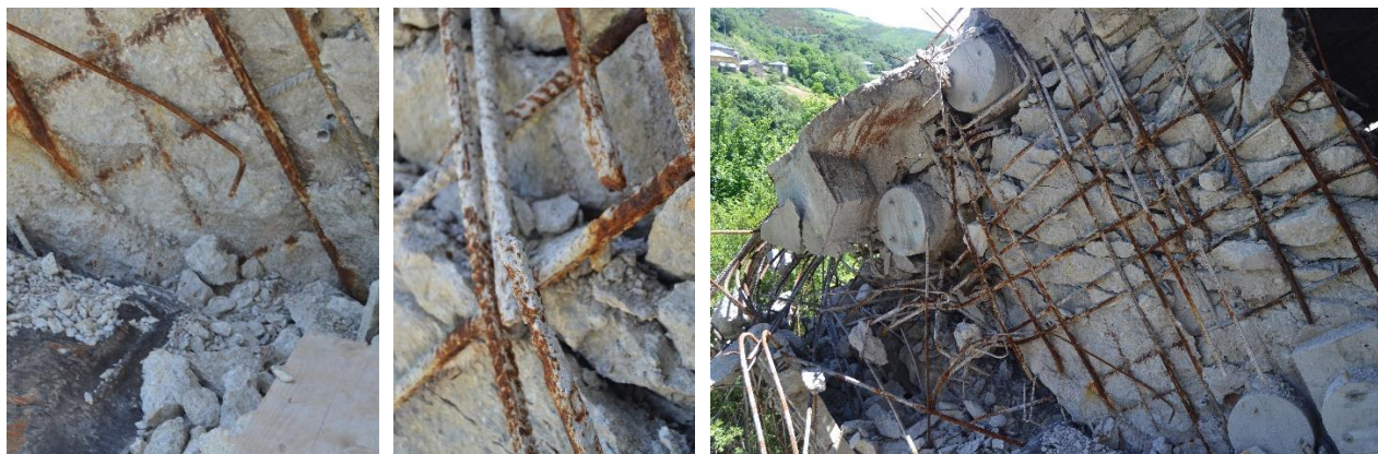
Figura 44. Mamparo de pila P3 del vano 3 del viaducto sentido A Coruña tras el colapso. Estado de durabilidad deteriorado.
