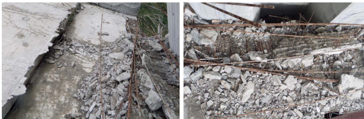
Figura 51. Mamparo de pila P1 del vano 1 del viaducto sentido A Coruña tras el colapso. Zona de contacto entre la dovela extrema y la adyacente. (Fuente: [19])
