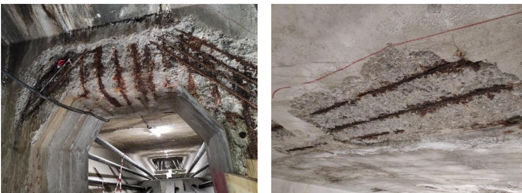
Figura 23. Daños durables en superficies interiores. (Fuente: [5]).
