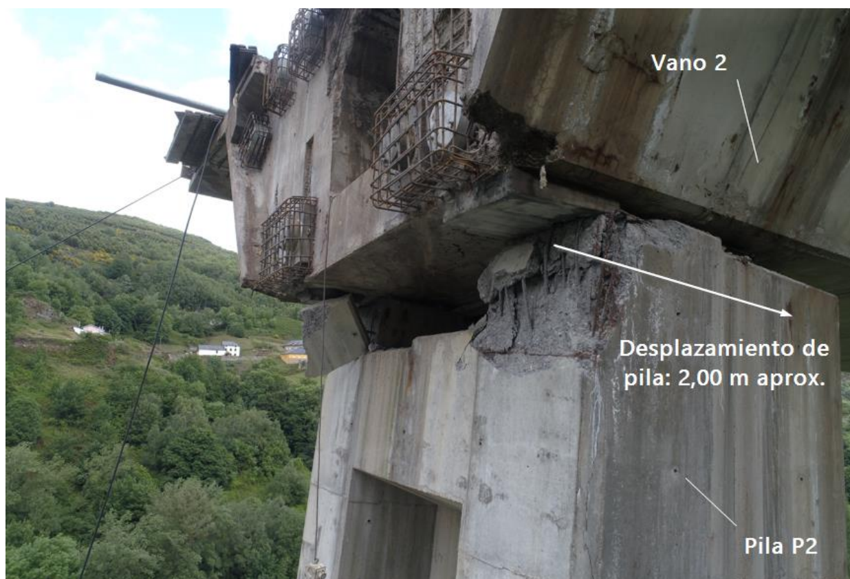
Figura 31. Situación de la coronación de la pila P2 tras el colapso del vano 3. (Fuente: [7]. Elaboración propia).
