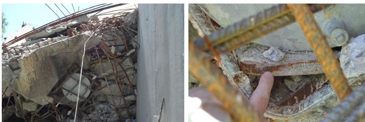
Figura 52. Mamparo de pila P3 del vano 3 del viaducto sentido A Coruña tras el colapso. Hundimiento de anclajes. Rotura de placa.
