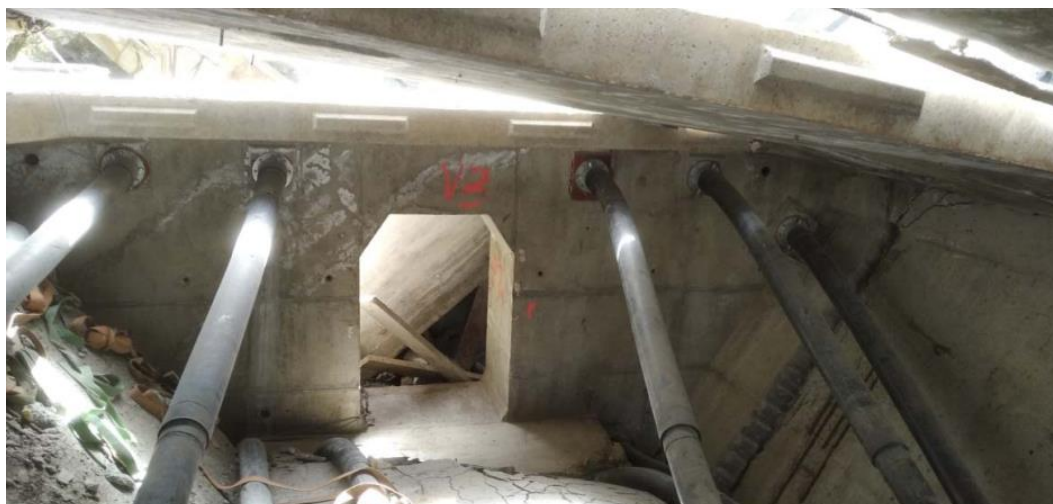
Figura 38. Mamparo de pila P2 del vano 3 del viaducto sentido A Coruña tras el colapso. Vista interior. (Fuente: [19])
