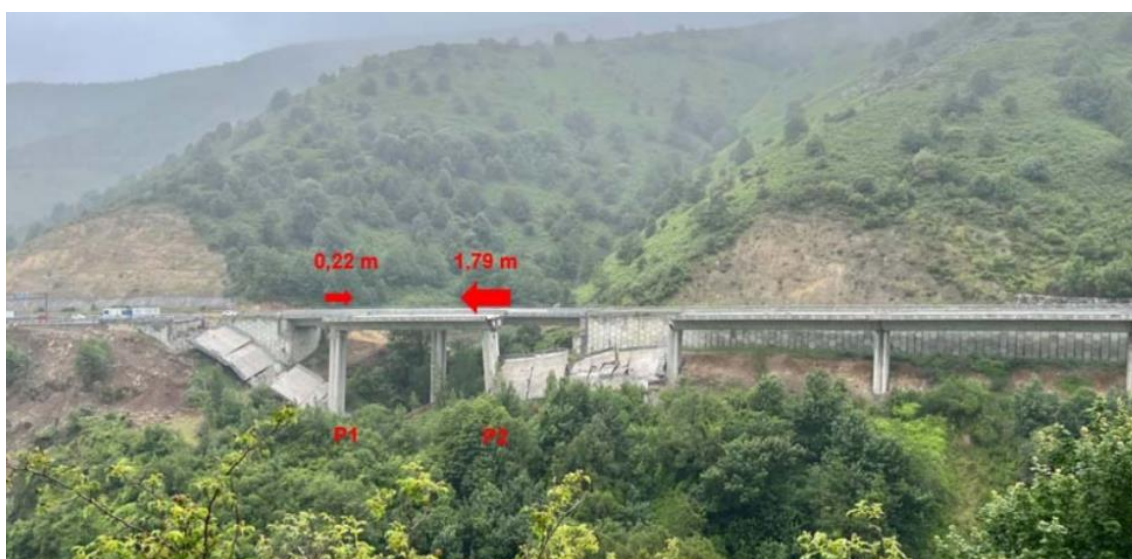
Figura 46. Situación de las pilas P1 y P2 tras el colapso de los vanos 1 y 3. (Fuente: [19])
