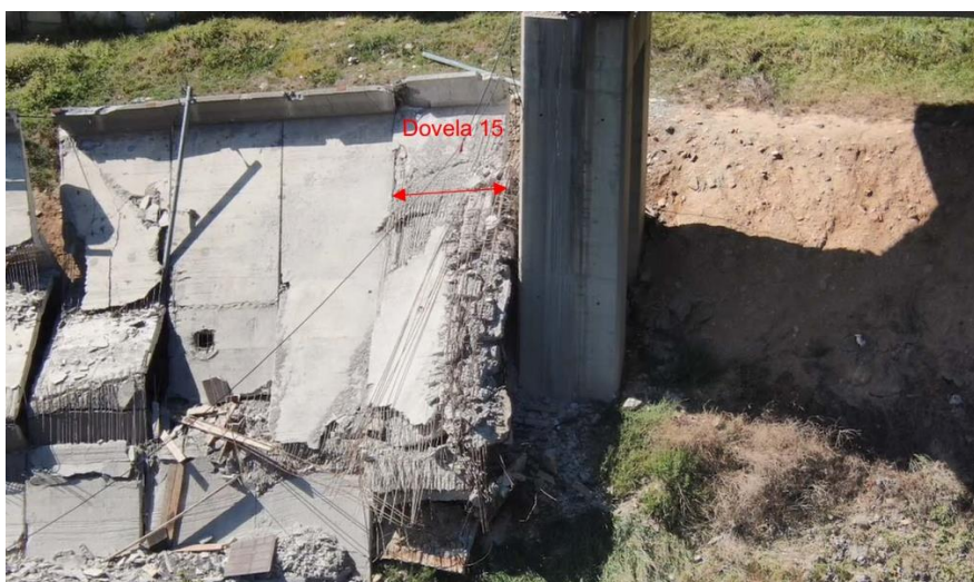
Figura 40. Mamparo de pila P3 del vano 3 del viaducto sentido A Coruña tras el colapso. Vista exterior. (Fuente: [19])
