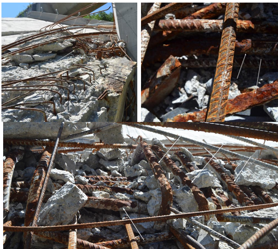
Figura 53. Mamparo de pila P3 del vano 3 del viaducto sentido A Coruña tras el colapso. Corrosión en armaduras.
