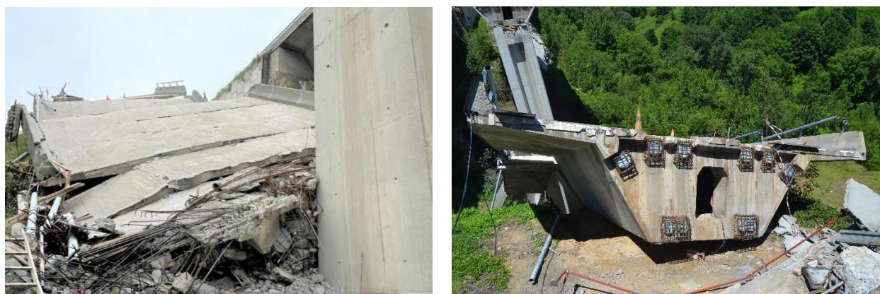
Figura 35. Dovela del mamparo de pila P1 (izq.) con elevado nivel de daños, en comparación con el mamparo de estribo E1, aparentemente íntegro.
