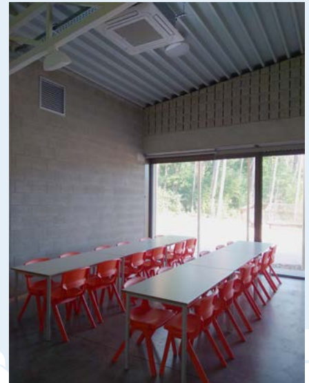
Bepaalde types warmtepompen kunnen gebouwen ook verkoelen.
